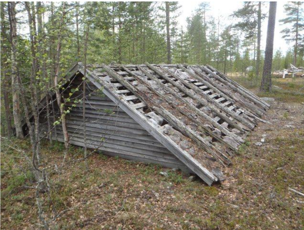
Halkokatoksen katto, jonka pystyt ovat pettäneet, kuvattu länteen.
