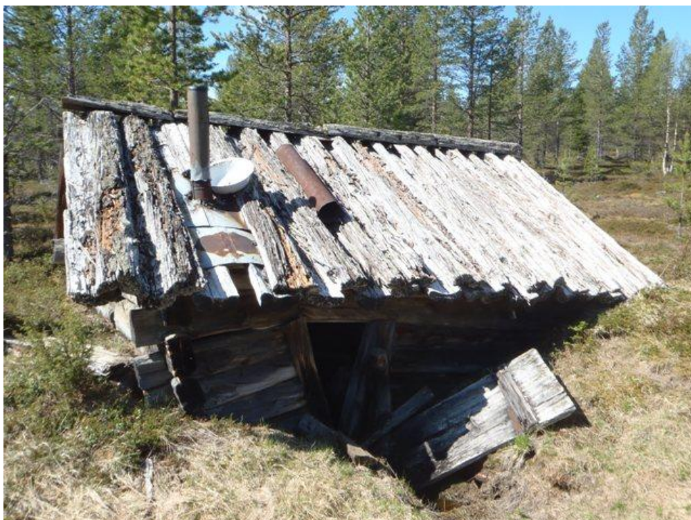
Kämpän toinen pää on upponnut ja rakenne vääntynyt, kuvattu länteen.
