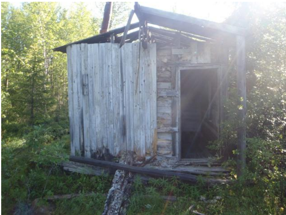
Saunan katto ja seinät ovat jo osin hajonneet, kuvattu itään.
