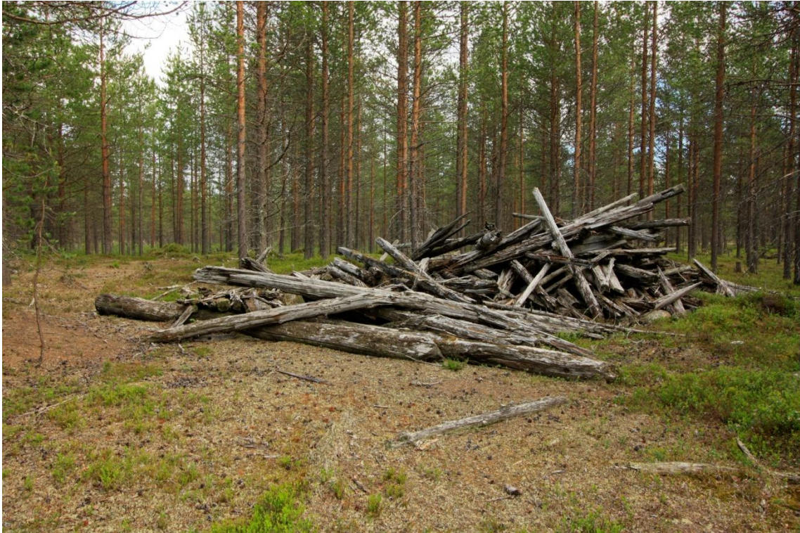
Kuva 219. Todennäköisesti Samperin veturitiehen kuuluneen sillan purettuja rakenteita.
