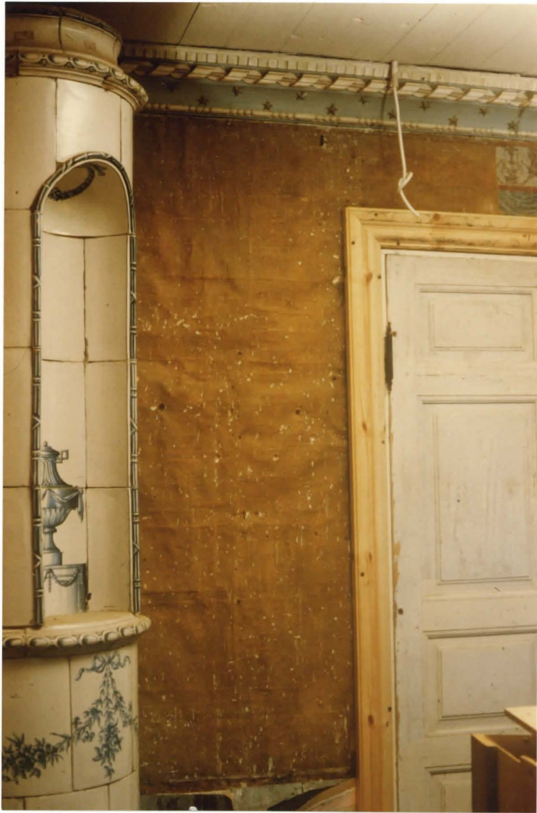
I FÖRMAK eteläseinä paperitapettien poiston jälkeen. Oven yläpuolella on näkyvissä esille otettua kustavilaista koristetta.
