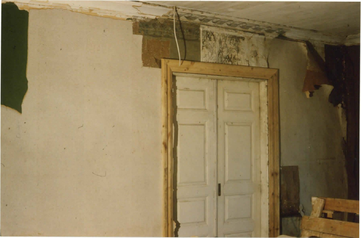
II SAL eteläseinän nykytilanne. Alkuperäinen kerros otettu esille oven yläpuolella. Puuttuneet vuorilistat on höylätty talossa säilyneen mallin mukaisena.
