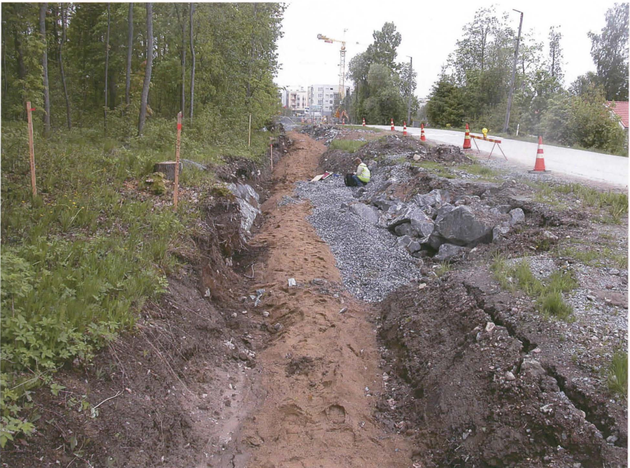
Kuva 2: Partolan kylätontin läpi luvottomasti vedetty vesihuoltolinjaan ja kevyen liikenteen väylään liittyvä kaivanto toukokuussa 2010. Partolanpuisto kuvan vasemmalla puolella. Kuvattu luoteeseen. Kuvaaja: Sami Raninen.
