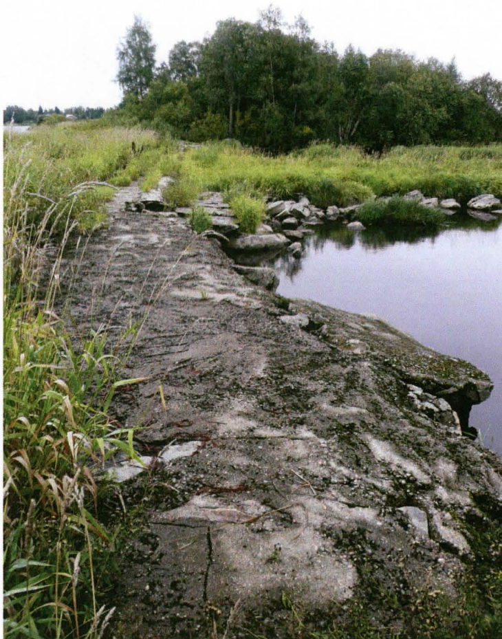
Kuva 18. Betonipatoa kuvattuna pohjoisesta.
