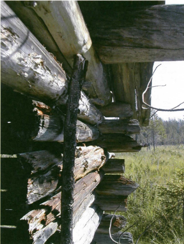
Rytisuo 2 nüttylato, 47468, pisteessä 7568187, 5605577. Nurkan yksityiskohtia. Reiska väittää ladon rakennetun vuonna 1970. Paremminkin vaikuttaisi siltä, että latoa olisi ekkä tuolloin korjailtu. Muun muassa kurkibirret vaikuttavat jälkikäteen vaihdetuilta. Kuvattu 24.7.2009.
