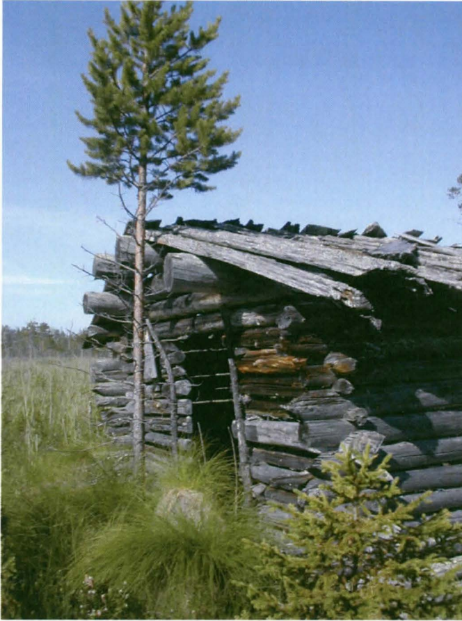
Rytisuo 2 nüttylato, 47468, pisteessä 7368187, 3603577. Reiska väittää ladon rakennetun vuonna 1970. Paremminkin vaikuttaisi siltä, että latoa olisi ekkä tuolloin korjailtu. Muun muassa kurkibirret vaikuttavat jälkikäteen vaihdetuilta. Kuvattu 24.7.2009.
