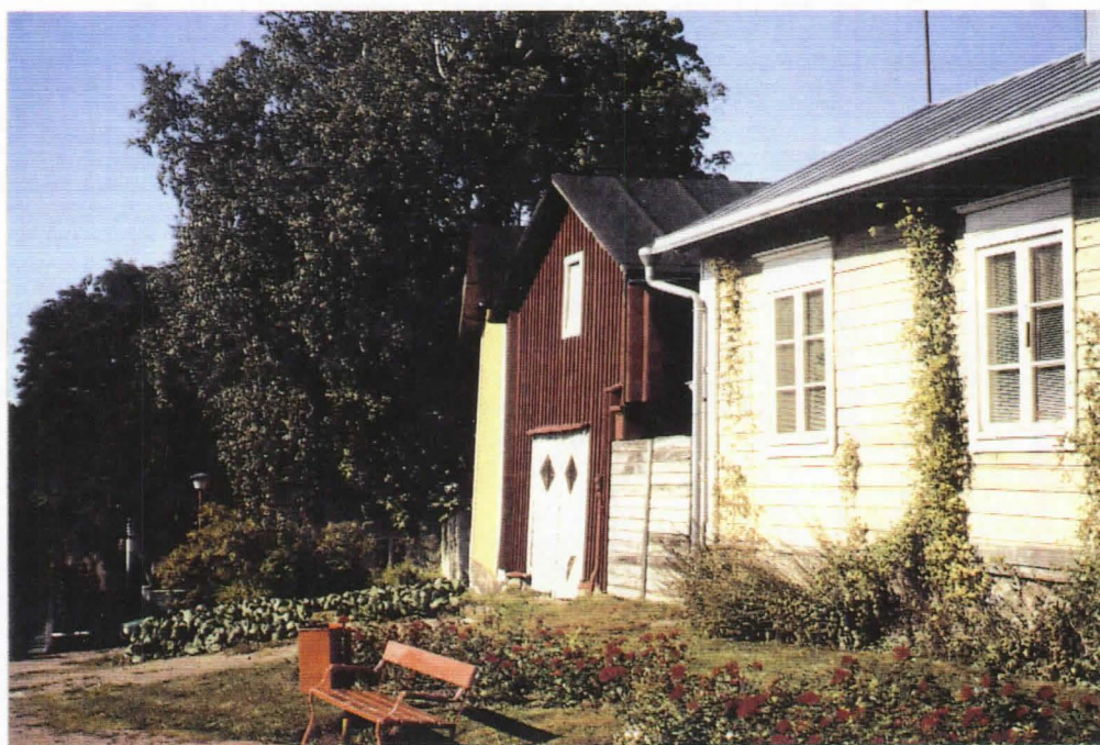
Korjattua aitan päätyä Linsenin Puistoon päin. Toisen kerroksen ikkunan korjaus on kesken.
