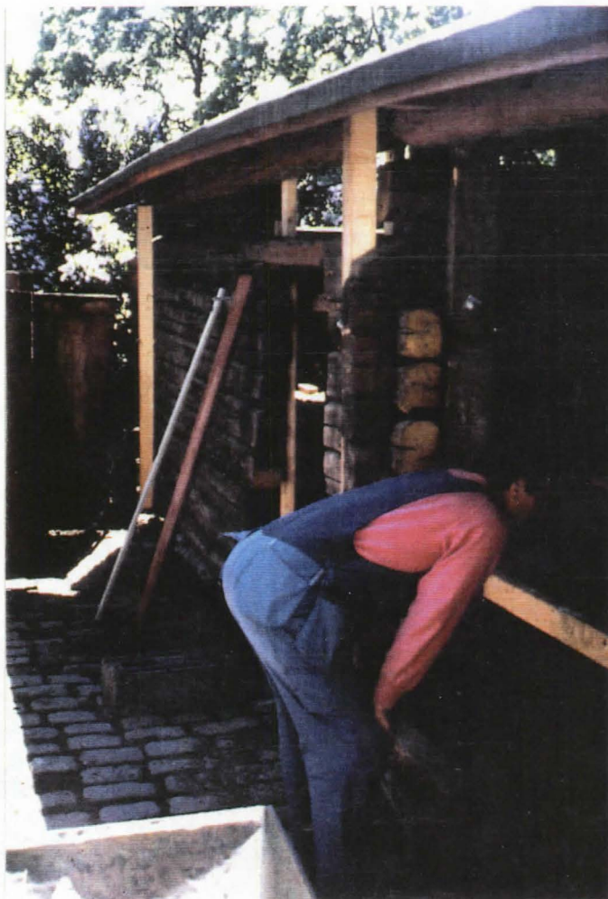
Rungon paikkaaminen pihan puolella tarkastelun alla.
