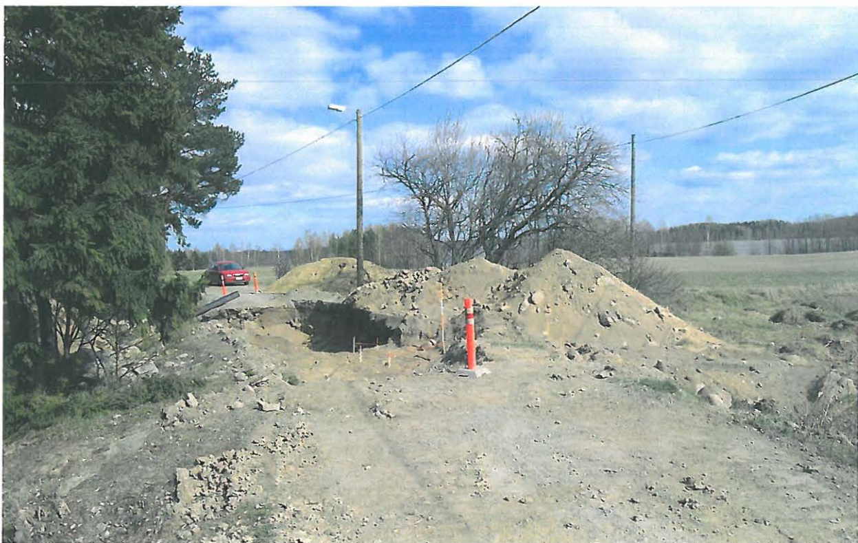
DSCN9732.JPG Valvonta-alueen SW-osa. Yleiskuva tulisijan löytöpaikasta lännestä. Tulisijan alue on rajattu paaluilla ja värinauhalla; linjakeppi on pisteessä "0".
