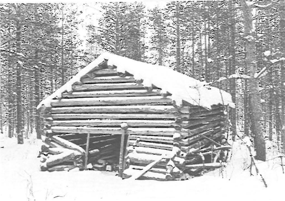
Tolla ennen korjausta .
