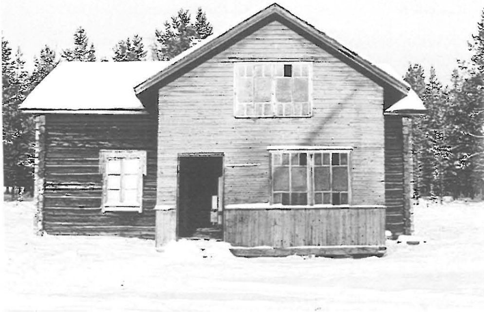
Päärakennus ennen korjaustyötä; huom. ulko-ovi hävinnyt
