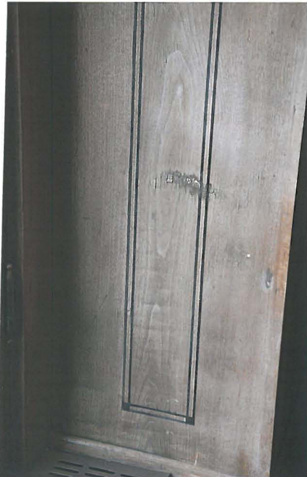
Huoneen 105 jalopuupaneelit ovat haalistuneet voimakkaan UV:n vaikutuksesta.
