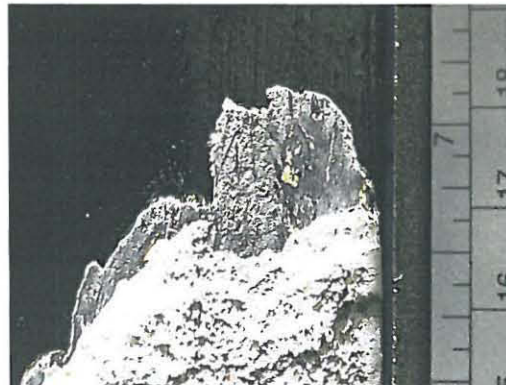
Turkkilaisen huoneen ikkunan pieessä vauriokohdassa erottuu ikkunapielen alinta ruskeaa värikerrosta [3.
