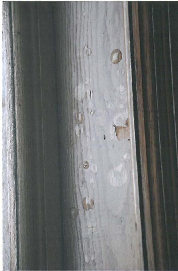
Huoneen 105 ikkunoiden lakkauksissa on voimakasta kuplimista, myös UV:n ja voimakkaan auringon lämmön vuoksi.
