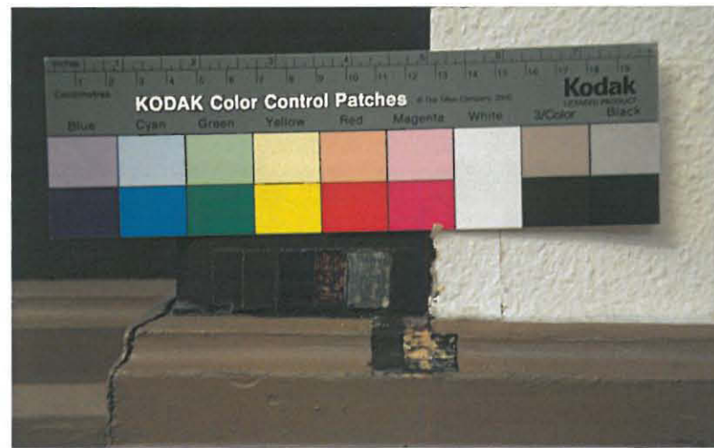
Väriportaikko takan viereisellä seinällä. Pystypalkki on maalattu ja seinäpinta tapetoitu. Harmaa maalipinta punaisen alla [2].
