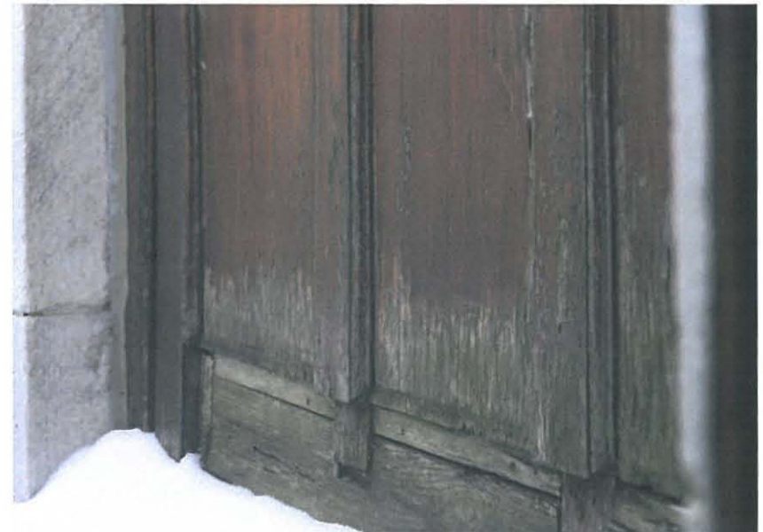
Seisonut lumi on aiheuttanut julkisivun terassien ovipinnoille vaurioitumista. Maalittomissa kohdissa puu on kärsinyt ja pinnassa on leväkasvustoja.
