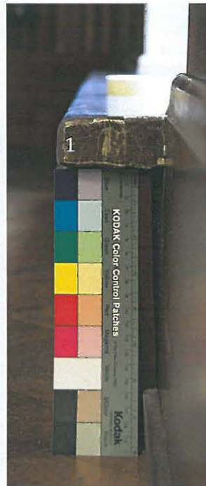
Ikkunapenkin reunassa sijaitseva esiinotto [1.
