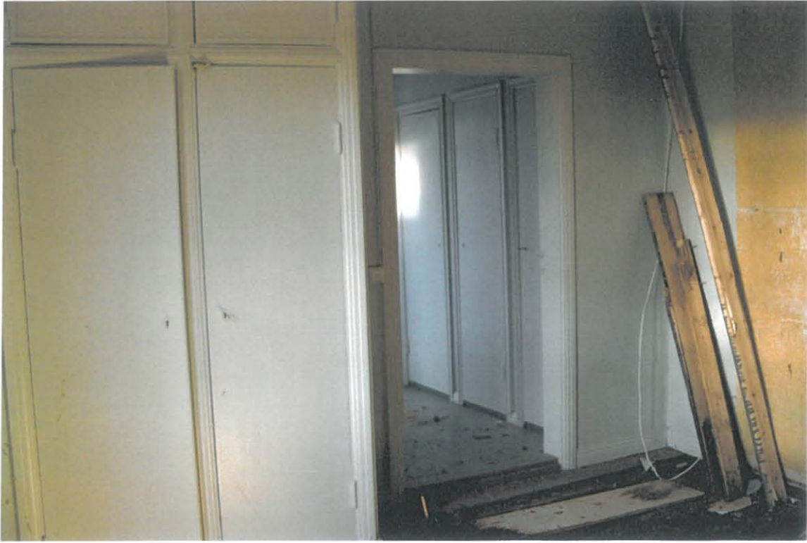
Seinä 3 ja 2, loisteputkivalo
