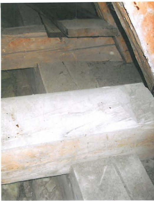
Jalasparruun on tehty lovet kämpälää varten siten, että kämpälän yläpinta on 8 cm jalasparrun yläpinnan yläpuolella.
