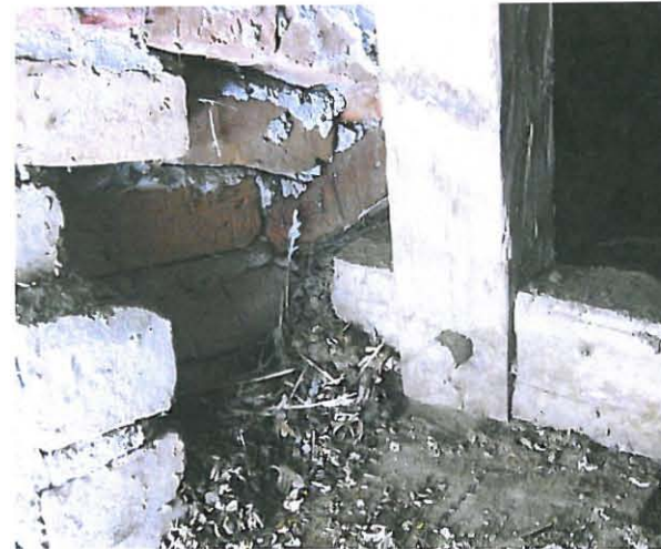
Holvin muuraus väistää kattotuoleja.
