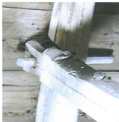
Auennut saksen yl liitos.
