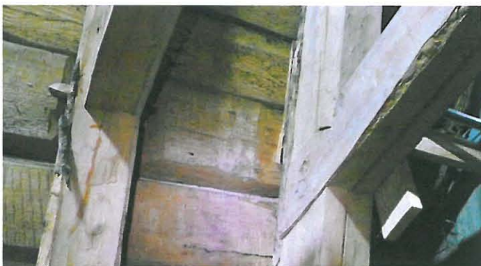
Runkohuoneen puoleisin kattotuoli on asetettu paikoilleen eri päin kuin muut kattotuolit.
