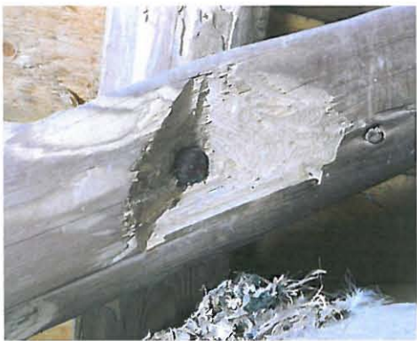
Diagonaalit on kiinnitetty takonauloin, joita varten puuhun on tehty kirveellä upotukset naulojen pituuden säästämiseksi.
