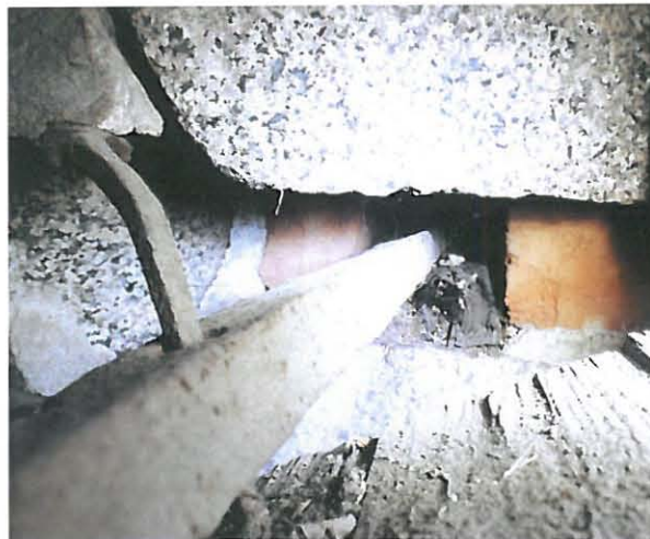
Hiiltynyt ankkurihirren pää päätymuurauksen sisällä.
