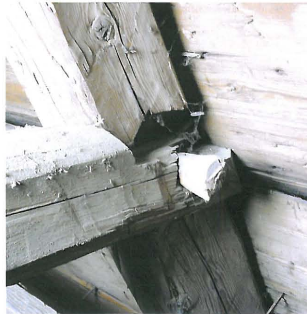
Tappi on paikalleen lyötäessä lohkaissut irti kitapuun pään kynttä varten tehdyn loven ja puun pään välisen osan. Kuva on Vanajan kirkon kattorakenteesta.
