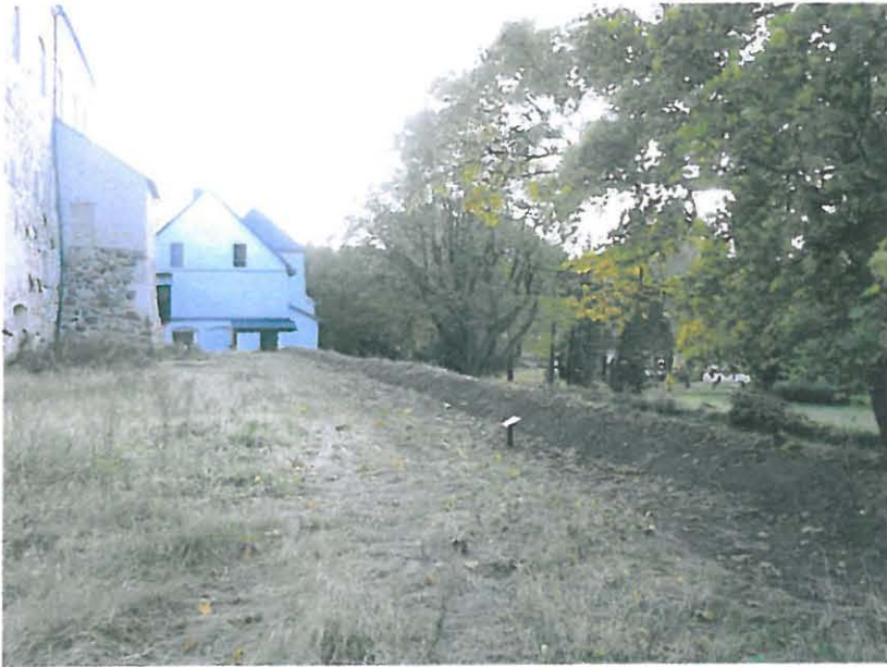
Korotus valmiina pajapihalta katsottuna. Kyltit varoittavat reunalla olevasta pudotuksesta.
