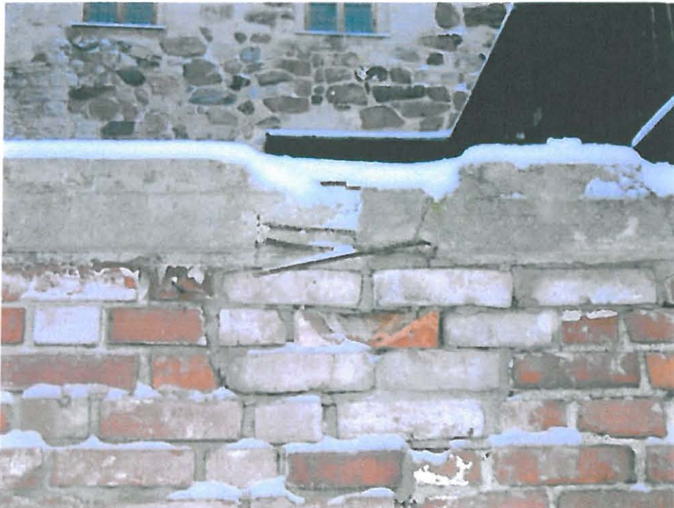
Muurin päällä oleva betonipalkki oli paikoin pahasti vaurioitunut ja siinä olleet harjateräkset olivat hyvin pinnassa.
