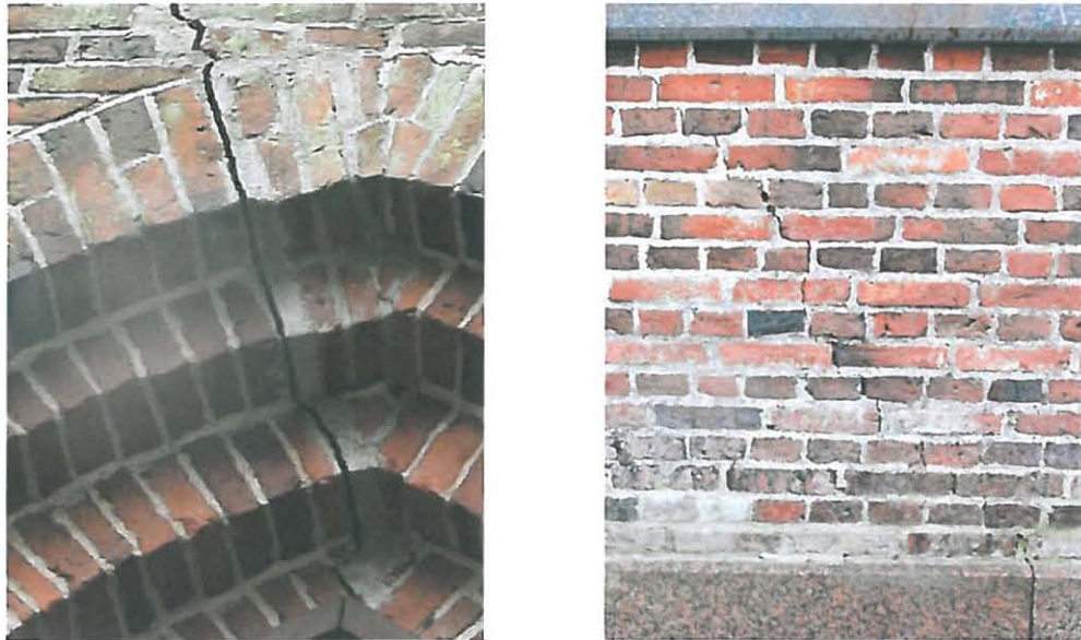
KUVIO 16. Halkeamia ulkoseinissä: ulko-oven yläpuolella ja seinässä ikkunan alapuolella.
