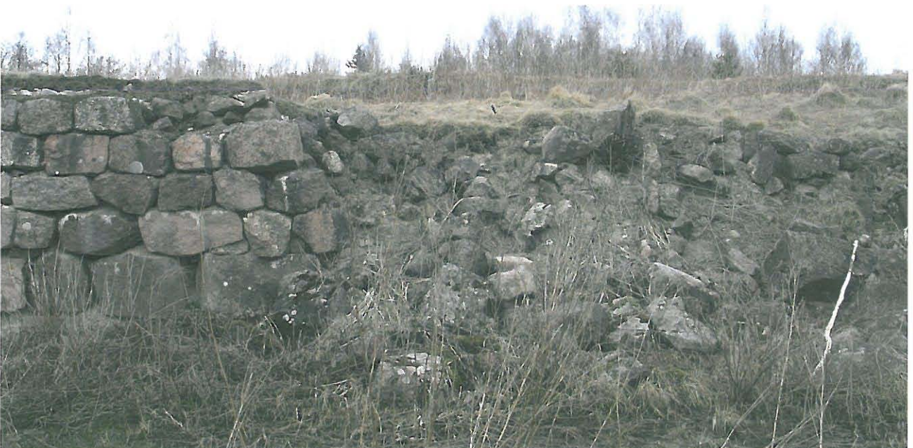
Rikkoutunutta ja pystyssä olevaa vastamuuria bastioni 3 edustalla. Matalaa rintamuuria näkyy ylemmässä kuvassa.
