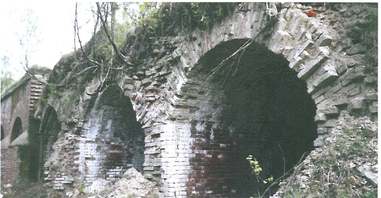
Rikkoutuneita kasematteja, alakuvassa vasemmalla näkyy korjattua tiiliseinämää.
