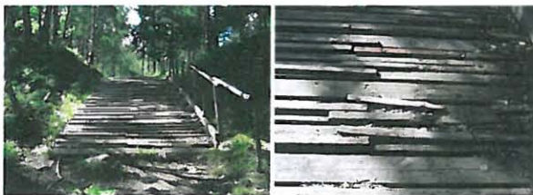
Kuva 68: Vanha silta on liian jyrkkä ja huonossa kunnossa.
