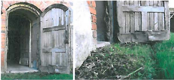
Kuva 18: Oviaukkoon tarvitaan maannosto ja/tai luiska portaan ja vesiojan vuoksi. Holvikaaren muotoinen ovi on suosituksia matalampi, mutta siinä on onneksi säkkikankaaiset eristeet pehmusteina.
