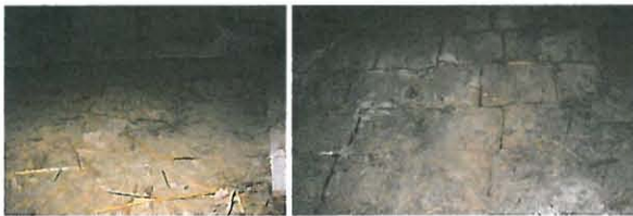
Kuva 24: Lähinnä ikkunaa olevan pilttuun lattia on epätasainen ja kaikkein huonoimmassa kunnossa.
