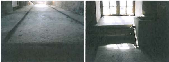
Kuva 27: Käytävälle on korkea kynnyks ja sen lattialla on uria. Käytävän perällä tilaa rajoittavat putket ja kiinteä vesiastia.
