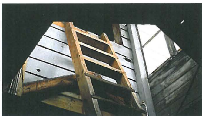
Kuva 8. Siniharmaata värikerrosta tornin ullakolle vievässä erkkerimäisessä porrashuoneessa. Porrashuoneen sijainti näkyy liitteessä 3/1, kuvissa 1 ja 2.
