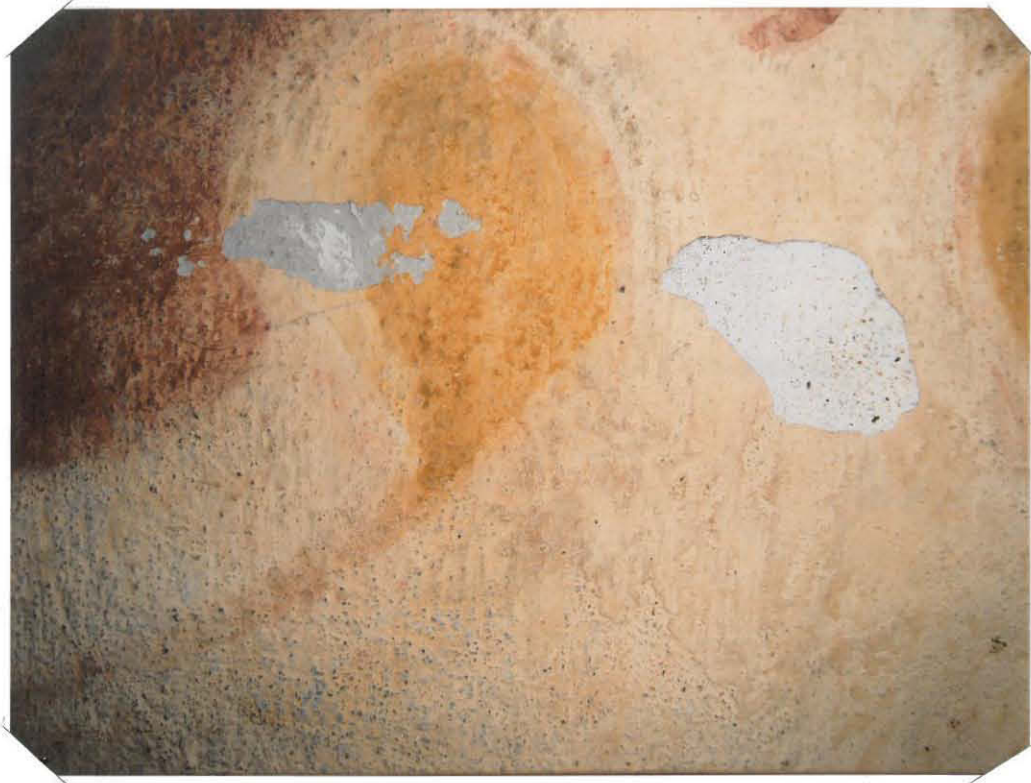
SINIHARMAA YLIKALKKAUS 1800-LUKU NYK. PINTA 1930-LUVUN KORJAUSSELMÄKÖS (POTO. IKKUNAN YÄS. PUOLI)
