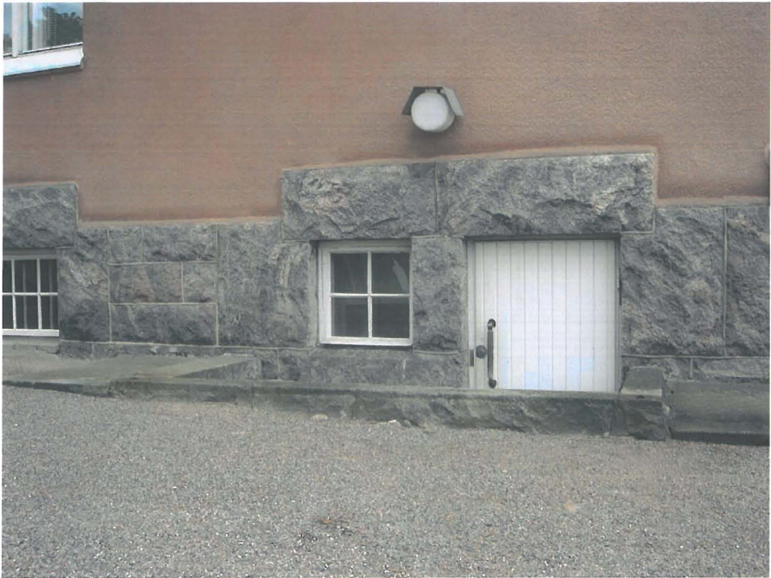
Tasoero kellarin sisäänkäynnillä aiheuttaa putoamisvaaran
