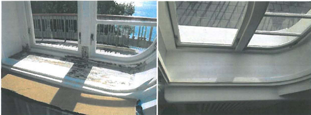
Kuva 23. Yläkerran ruokasalin ikkuna F213. Alakarmista on poistettu isoja lasikuitukangaspaloja maalikerroksineen.
