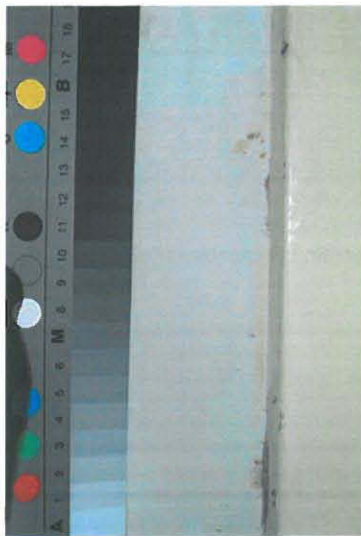
Kuva 51. Ikkunoista F203-205, yläikkunan karmin vaalean vihertävää maalikerrosta
