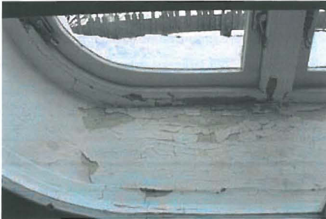
Kuva 22. Yläkerran ruokasalin ikkuna F213. Maalipinnan kunto ennen toimenpiteitä.
