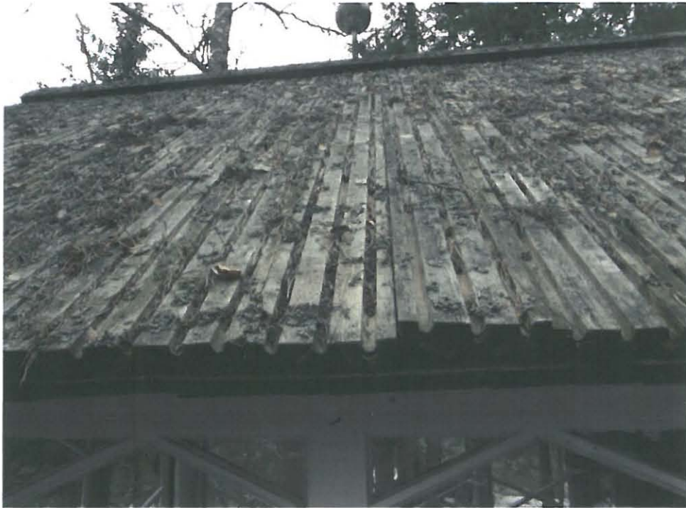
Kuva 3 Katto ennen kunnostusta
