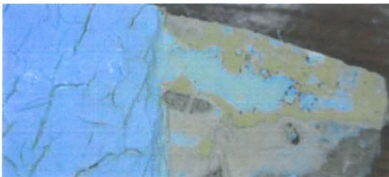
Keltaista maalipintaa irrallisesta maalinäytteestä
