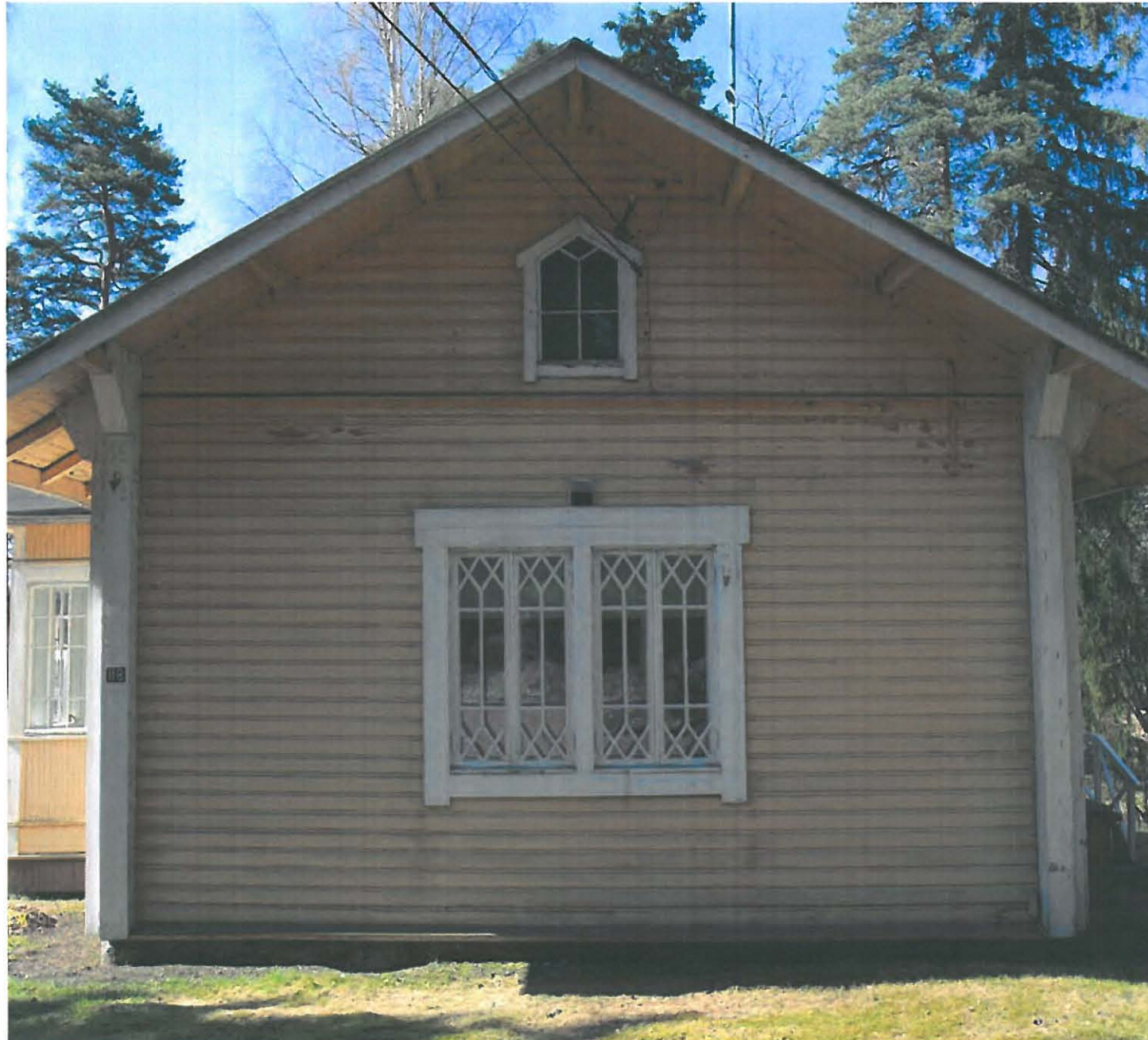
Julkisivu (Julkisivu koilliseen) Maalipinta irtoilee.
