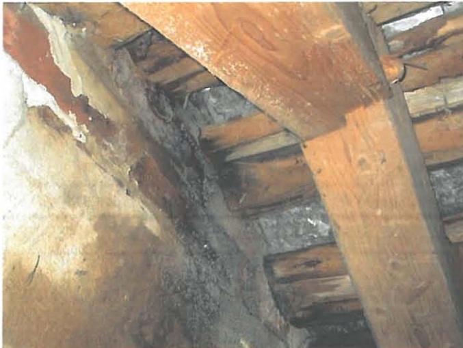
Kuva 2. Kosteusvaurioita pöpun vieressä
