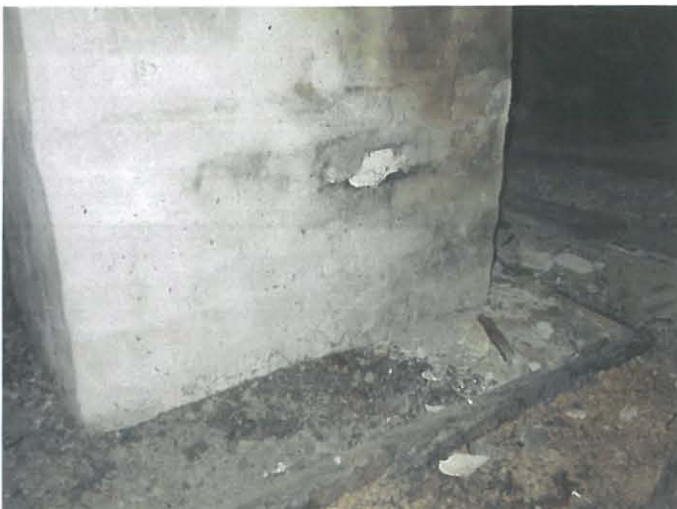
Kuva 3. Rapautumista hormin rappauksessa
