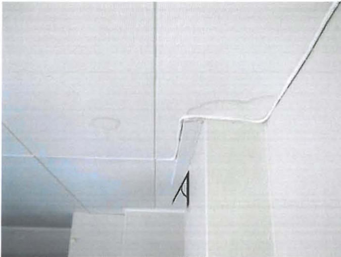
Kuva 16. Kosteusjälkiä ison huonetilan katossa
