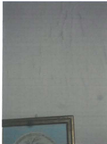
Huone 14. Epäonnistunut pintakäsittely.
