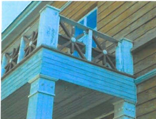
Suojaamattomat ulkonevat kuistit ja parvekkeet vaativat jatkuvaa huoltoa.
