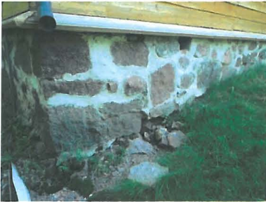
Liikkumisen aiheuttamia halkeamia ja kivien irtoilua rakennuksen pohjoispäädyssä.
