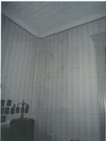
Huone x. Valumajälkiä. Toisella puolen seinää on hormi.
