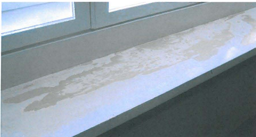
Kuva 2. Sisältäpäin katsottuna ateljeen vasemmanpuoleinen ikkunalauda öljysilotteineen, ja hiottuna.
