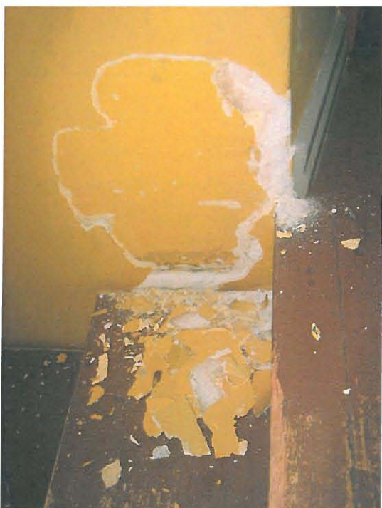
Kuva 6. Seinästä irti oleva laasti.
