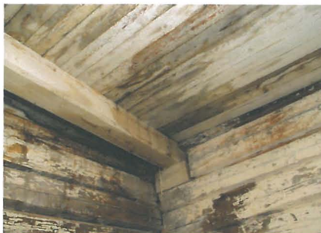
Vesikaton vuotojen jälkiä tallin 105 nurkassa.
