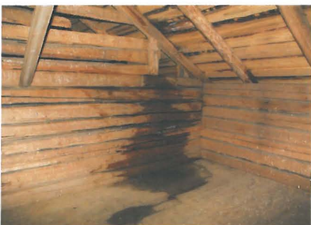
Vuotokohta aitan 101 ylisillä. Hirsiseinä ei vielä ole pahasti vaurioitunut, mutta katon korjaus on kiireellinen.
