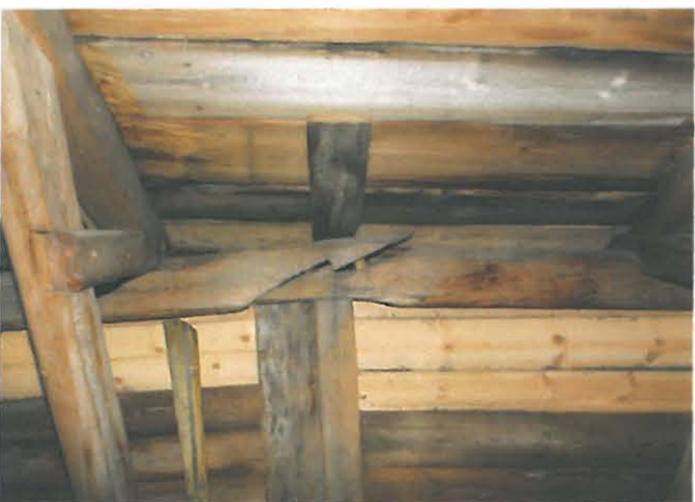
Piirurungon yläjuoksun jatkos varaston ylisillä (204). Liitos on auennut seinän alapään lahoamisen ja kivilajan painumisen takia. Oikealla tallin 105 seinää, johon 1970-luvulla lisätty följari on laho.
