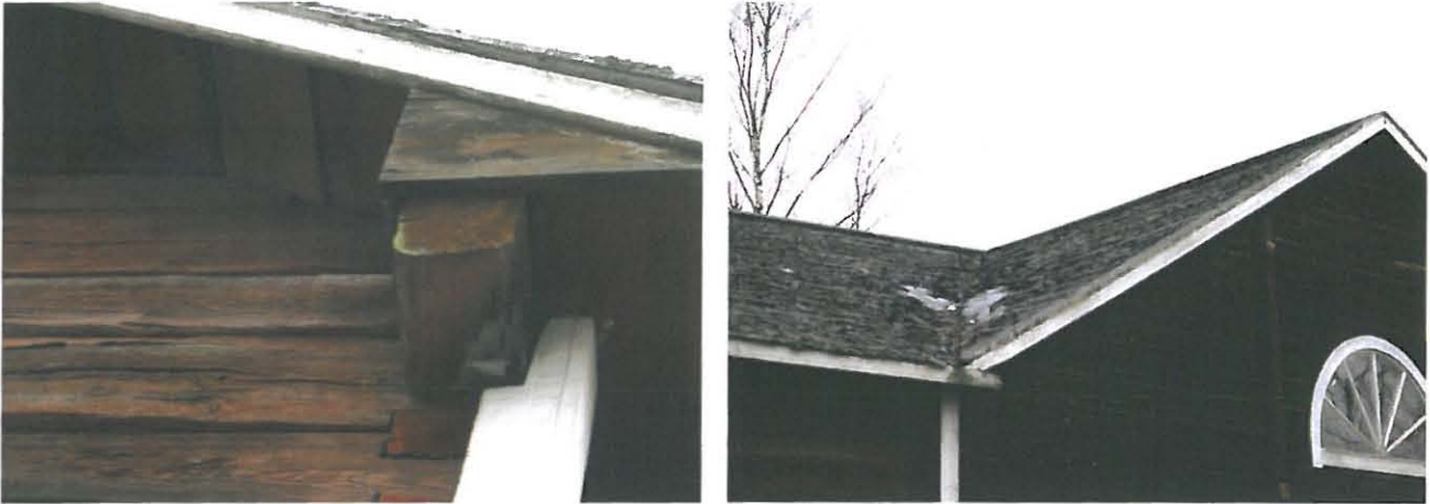
Aittapäädyn sivuräystäässä on alapuolella vaakalautoitus. Päätujen tuulilaudat ja katon harjalaudat ovat huonokuntoisia. Myös räystääslautoissa on lahovikoja.
