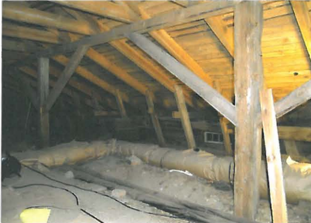
Vesikaton rakenteet uusittiin ilmeisesti 1940-luvulla. Kattotuoleja kannattaa kitapuitten alta väliseiniin tuettu pukkirakenne.
