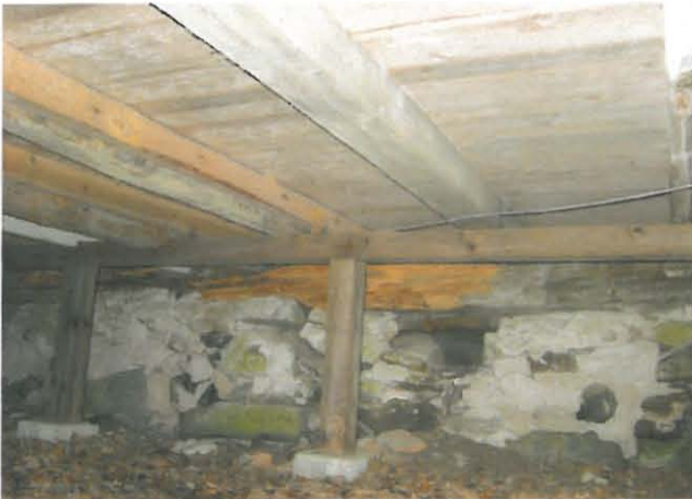
Lasikuistin lattian kannattajia. Päärungon seinän alin hirsi on osin laho, mutta vaurio on vanha eikä aiheuta toimenpiteitä.
