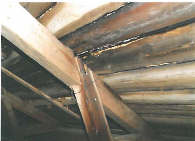
Märkää ja osin lahoa ruodelaudoitusta väliosan katossa.
