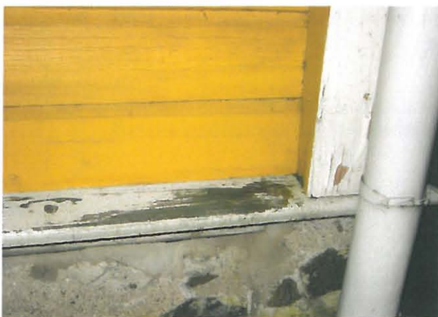
Sokkelin vesilistat uusittiin 1960-luvulla käyttäen painekyllästettyä lautaa. Listojen kallistus on paikoin liian pieni.
