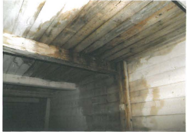
Tallin välikaton pahasti kostuneita ja osin lahoja rakenteita.
