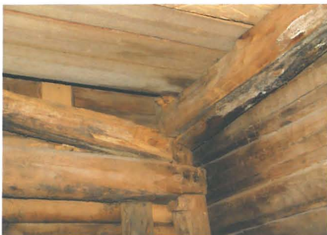
Vesikaton pitkään jatkuneet vuodot ovat pahasti vaurioittaneet välipohjaa ja ulkoseiniä tukevia rakenteita. Varasto 14.
