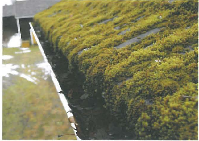
Räystäskourut ovat täynnä roskaa.
