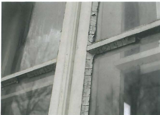
Kittaukset ovat monin paikoin lohkeilleet.
