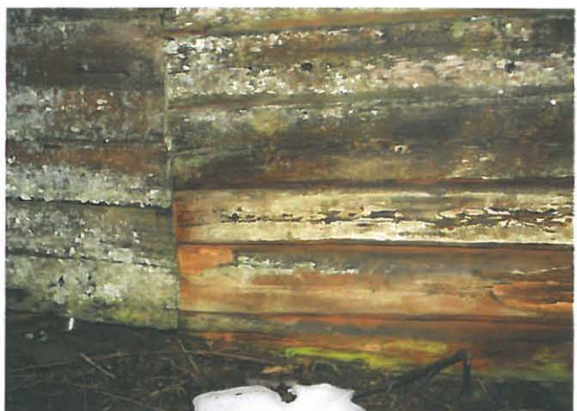
Koillissivun kosteaa ja jäkälöitynyttä seinää piirurunkoisen osan ja hirsirungon liitoskohdassa.
