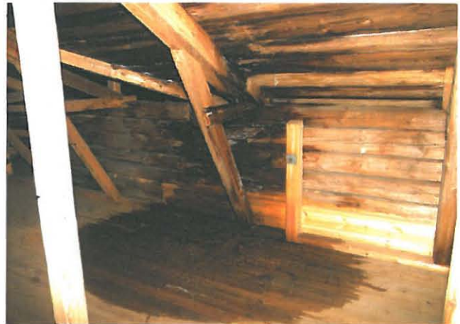
Pahasti tuhoutunut kattotuoli ja hirsiseinän osa tallin 105 ylisillä.
