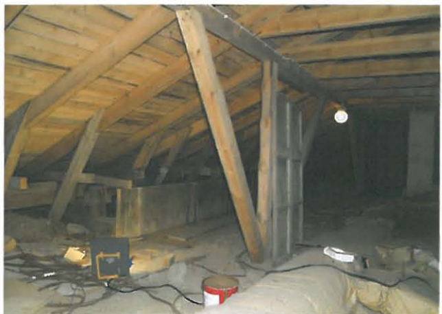
Salin kohdalla välipohjaan on lisätty ilmeisesti 1960-luvun korjauksessa vaneriumainen palkki (näky taustalla).
