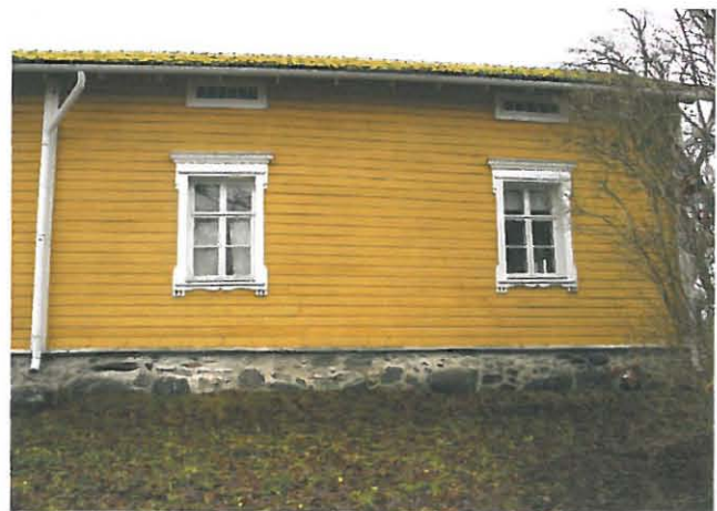
1960-luvun korjauksessa uusitut laudat erottuvat edelleen julkisivuissa (6 alinta lautaa).
