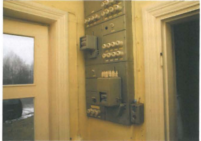
Päärakennuksen mittaritaulu sijaitsee ahtaasti eteisessä 102.
