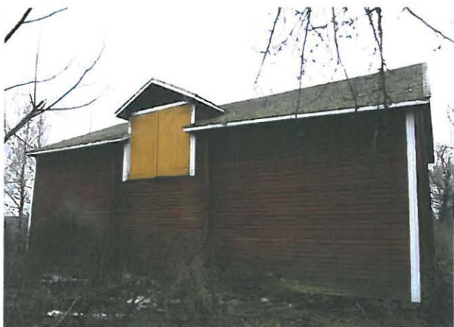
Tallin päätyseinä laudoitettiin kokonaan uudelleen 1970-luvun korjauksessa. Ylisille johtanutta siltaa ei rakennettu uudelleen.
