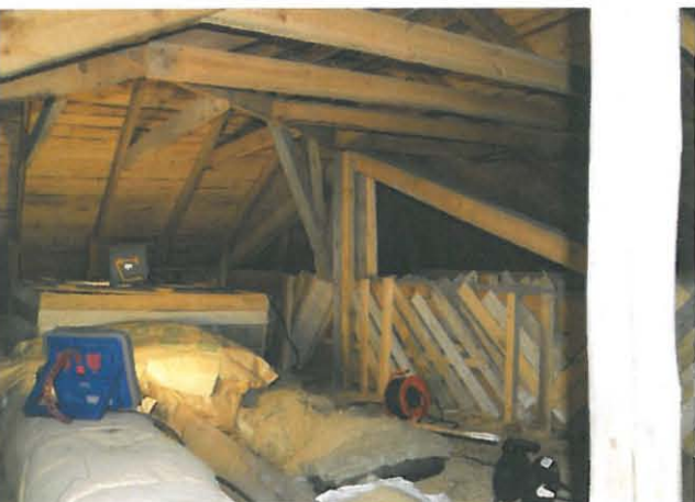
Välipohjaa kannattava ansas 1940-50-luvulta. Ansasta on vahvistettu epämääräisellä vinolaudoituksella.
