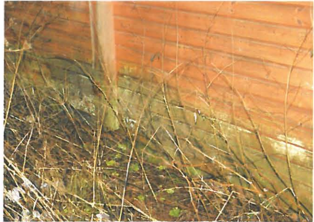
Maanpinnat rakennuksen ympärillä ovat nousseet ja kasvillisuus pitää seiniä kosteina.
