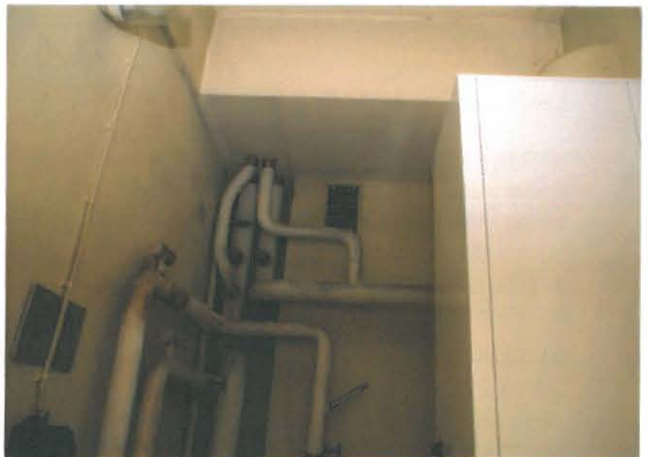
Ilmalämmityksen kiertoveden putkistoa kattilahuoneen yläosassa. Lämmönvaihdin ja puhallin ovat ullakolla.
