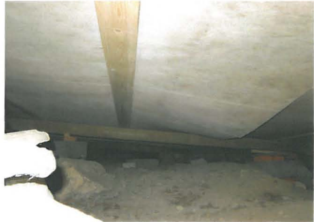
Salin 114 vuonna 1984 uusittua lattiaa altapäin. Täytepohjana olevat vanerit roikkuvat osittain irti.
