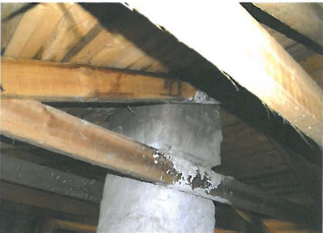
Vesikatossa havaittiin vain pieniä vuotoja, kiitos aluskatteen.
