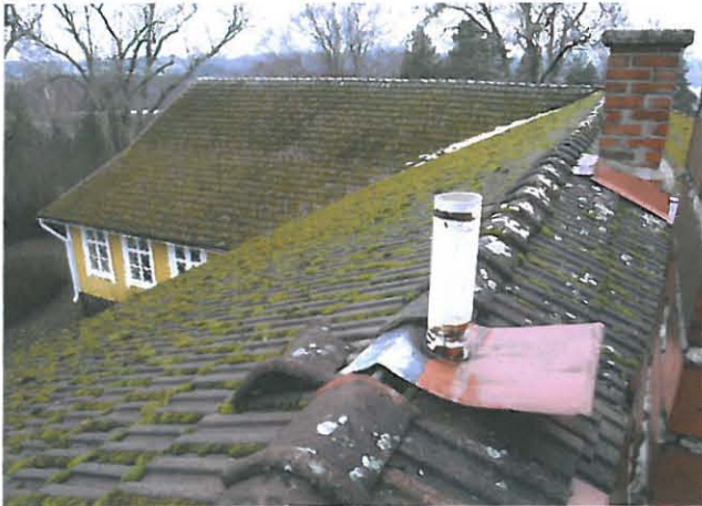
Tuuletusputken läpivienti vuotaa.
