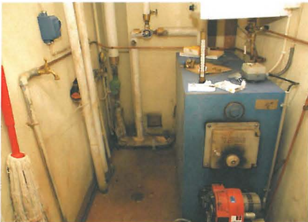
1960-luvulla tehty kattilahuone (103). Laitteet ovat pääosin samalta ajalta. Putkieristeissä on todennäköisesti asbestia.
