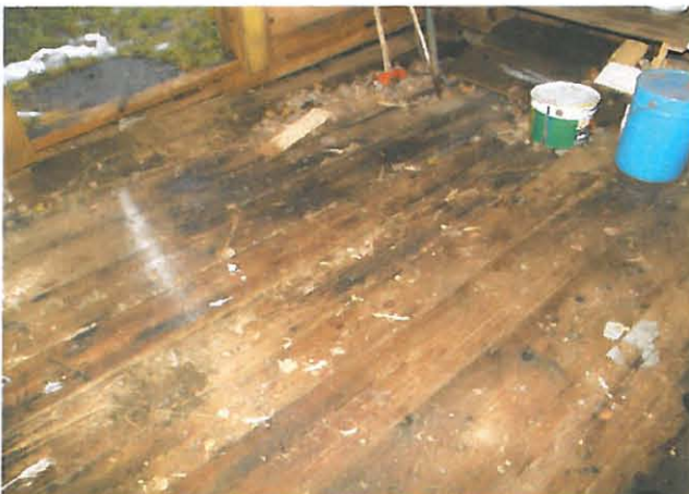
Työkaluvaraston 102 lattian niskat ja lankut ovat osin lahonneet.
