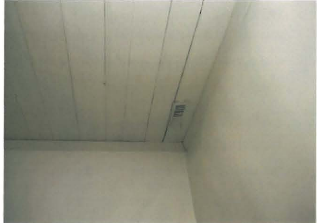
Museotilojen lämmitys on hoidettu lämminilmapuhalluksella, jonka poistoventtiilit ovat katoissa.
