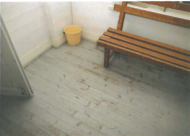
Lasikuistin katossa olleen vuodon aiheuttamia kosteusjälkiä lattiassa.
