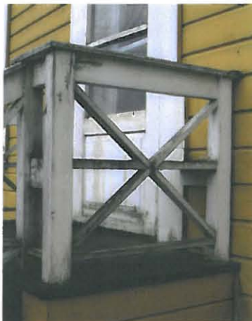
Portaiden rakenteet ovat kunnossa, mutta kaipaavat maalausta.
