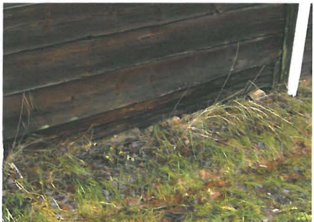
Maahan painunutta seinää pihatien varrella. Seinän alimmat rakenteet ovat todennököisesti lahot.
