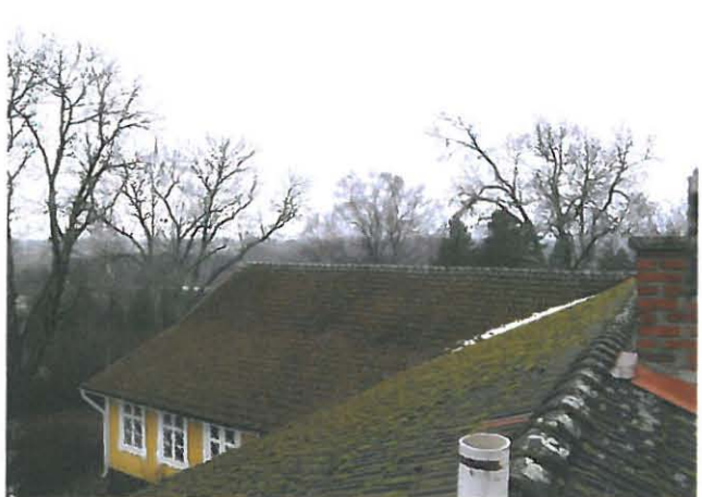
Ilmeisesti 1940-luvulta oleva tiilikate on sammaloitunut kauttaaltaan, tiilet ovat hauraita ja huokoisia.
