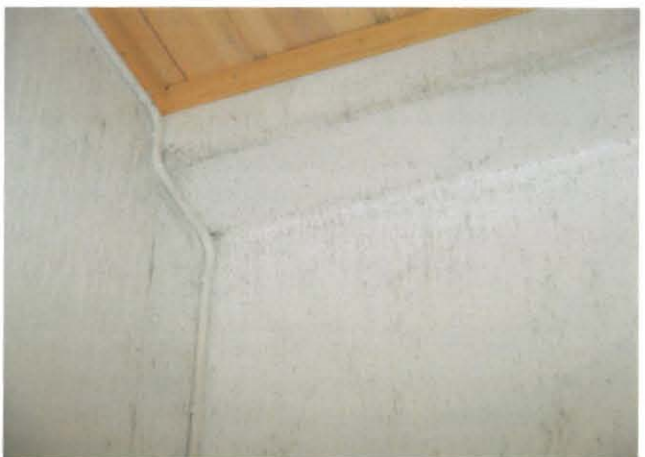
Asunnon yhteyteen 1980-luvulla tehdyn WC-suihkutilan seinät ovat homeessa. (huone 105B)
