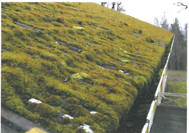
Umpeen sammaloitunutta, monin paikoin vuotavaa tiilikatetta. Tiilien aluskatteena olevan bitumihuovan on tarkoitus ohjata vuodot räystäskouruihin.
