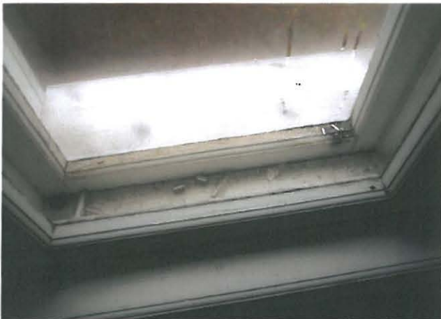
Etenkin auringonpuoleisilla sivuilla ikkunat ovat pahasti ravistuneet sekä ulkopuolelta että väleistä.
