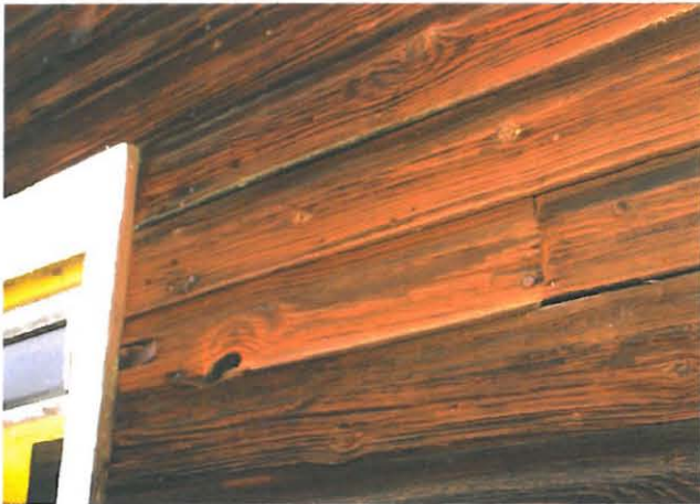
Tallirakennuksen pahasti ravistuneita ponttilautaverhouksia.
