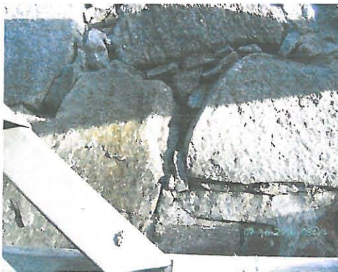
KUVA 5. Pohjoismuurin yläosa on joutunut kohtaamaan sateet ja tuulet.
