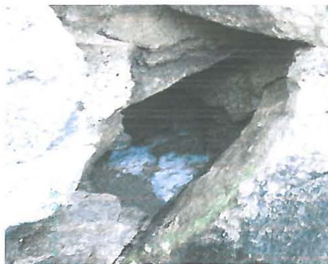
KUVA 4. Avattu halkeama länsimuurissa.
