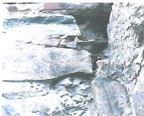
KUVA 2. Itä- etelänurkan avaus paljasti, että nurkkaukseen ei ole laastia lainkaan.
