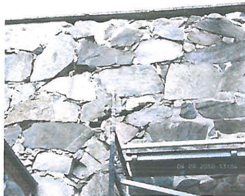
KUVA 6. Muurikivet ovat paikoitellen juottamisen tarpeessa ja kiilakiviä on irti.
