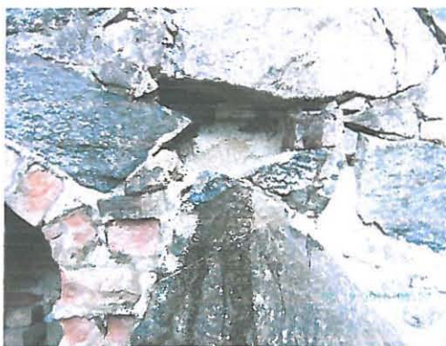
KUVA 3. Länsimuurista irronnut muurikivi.
