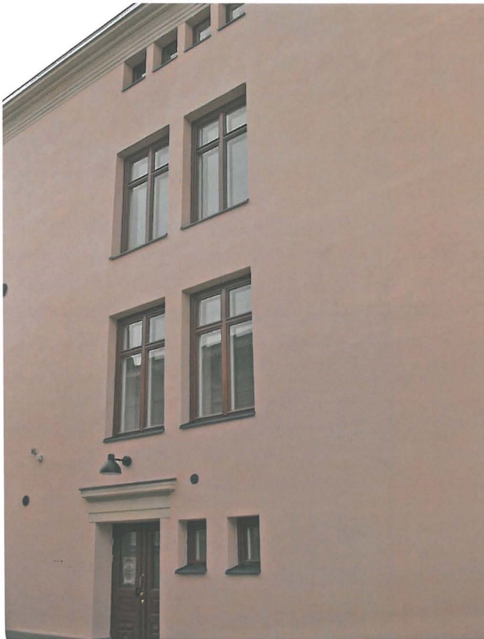
58. Alkuperäispiirustusten mukaan tämän päätyulkisivun aukoituksista yksikään ei ole alkuperäinen, vaan ne on toteutettu vuosien 1921-1922 laajennus- ja korjaustöiden yhteydessä.
