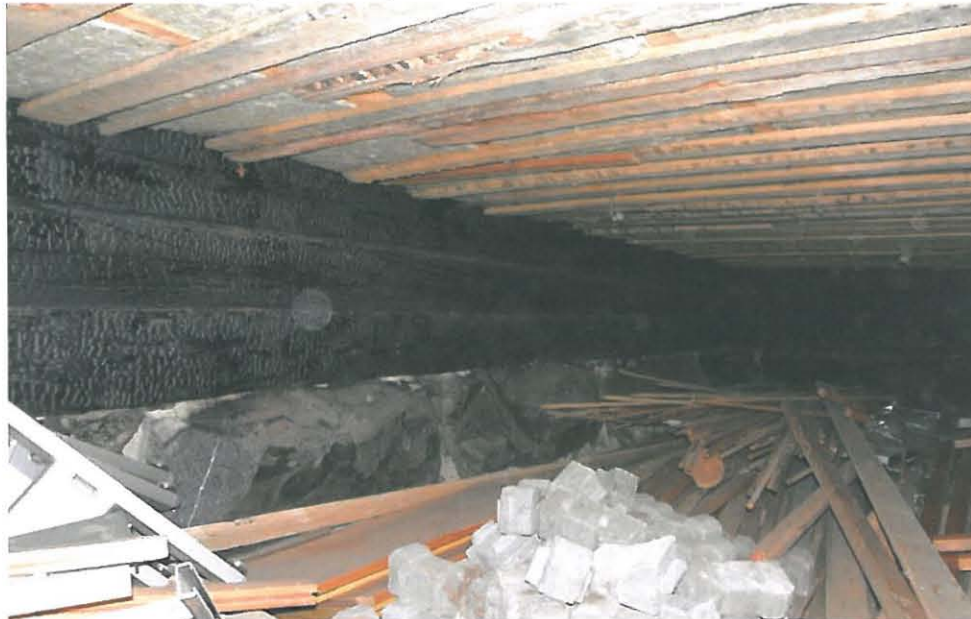
98. Rossitilassa on joskus syttynyt uhkaava tulipalon alku. Kuvassa näkyy hiiltyneitä hirsipintoja ja uusittua alapohjaa. Nykyisin tilassa säilytetään satunnaista puu- ja rakennustavaraa.
