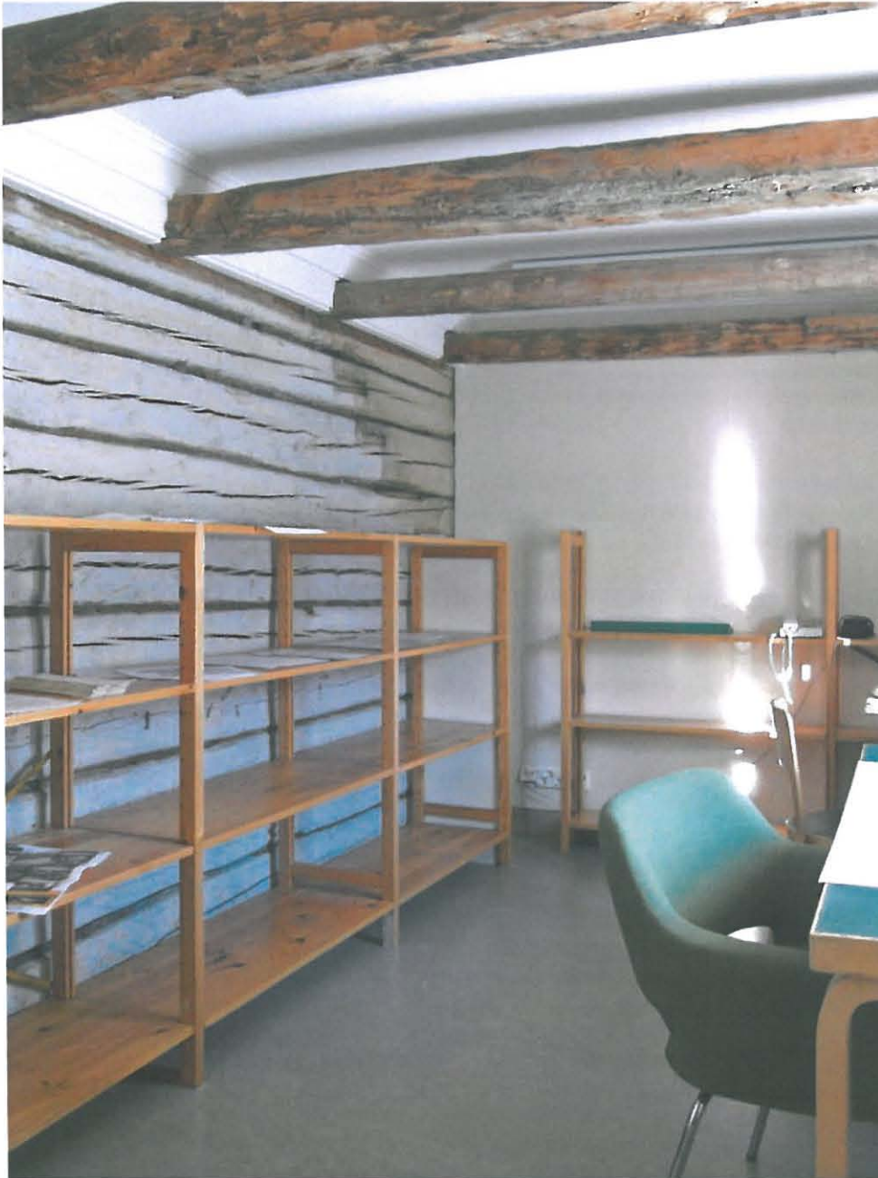
151. Kaikki rakennuksen tilat on muutettu lämpimiksi sisätiloiksi.
