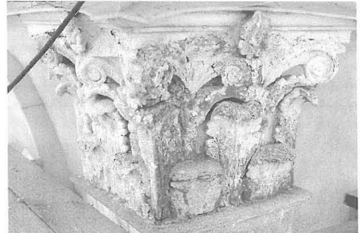
Luoteistornin lounaiskapiteelissa näkyi ilmaston vaikutus erittäin selvästi. Etelään suuntautuvan puolen kaikki osat jouduttiin uusimaan, länsipuolella lähes puolet olivat kelvollisia edelleen.
