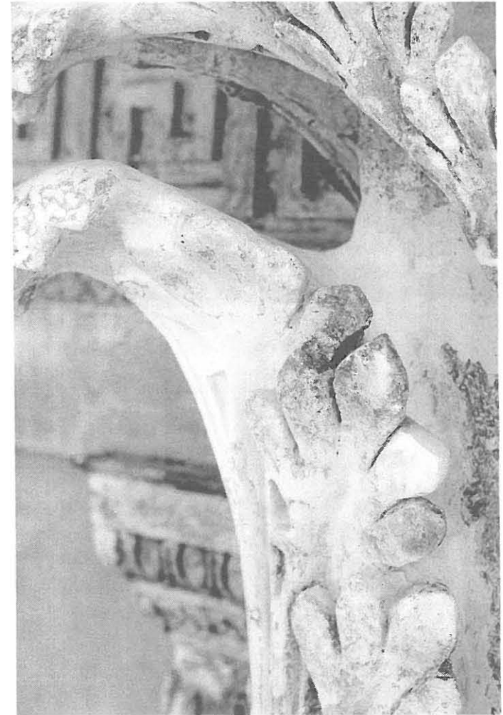
Tapulirakennuksen pahoin vaurioituneita kapiteeleja, etenkin etelän ja lännen puolella jouduttiin paikkaamaan varsin runsaasti kunnollisen maalaus pohjan aikaansaamiseksi.
