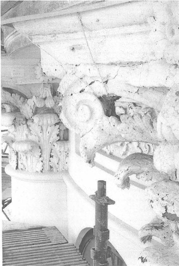
Keskitornin kapiteelien kunto ennen korjausten aloittamista. Useat kappaleet olivat haljenneet ruostuneiden, turvonneiden tukirautojen takia.
