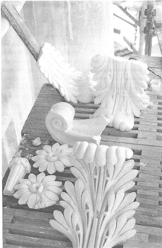
Keskitornin kapiteelien uusia valukappaleita kiinnitystä odottelemassa. Kukin kappaleista on yhdestä muotista valettu. Nykyään käytetty silikonimuotti on vanhaa liimamuottimenetelmää huomattavasti joustavampi ja sallii monimutkaisempien kappaleiden valamisen yhdestä muotista.
