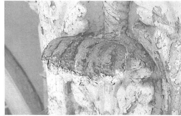
Eteläseinällä oleva matala akantus on 70-luvulla korjattu paikkaamalla, mutta koska vernissaus ja maalaus eivät ole toimineet halutulla tavalla, on korjaus vain antanut paremmat edellytykset vaurion kasvamiselle.
