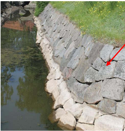
Kuva 04. Vaurion laatu ennen korjausta.
