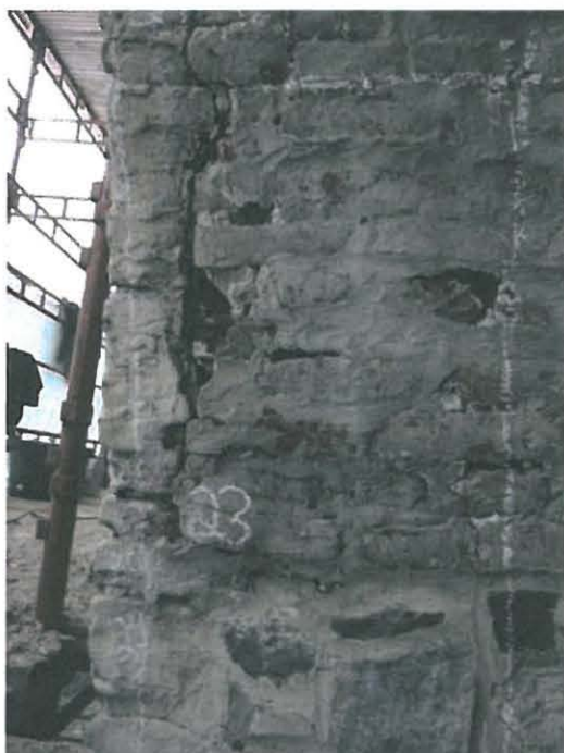
KUVA 13. Holvin pintaa on "korjattu" tiiviillä laastilla, jonka läpi muurin sisälle tullut vesi ei ole päässyt haihtumaan.
