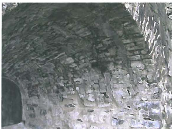
KUVA 26. Ampuma-aukossa L 102 holvin läpi kulkevia halkeamia on koko aukon syvyydellä.
