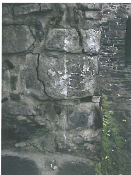
KUVA 25. Ampuma-aukko L 103. Kivi on haljennut ylhäältä tulevan painon alla.
