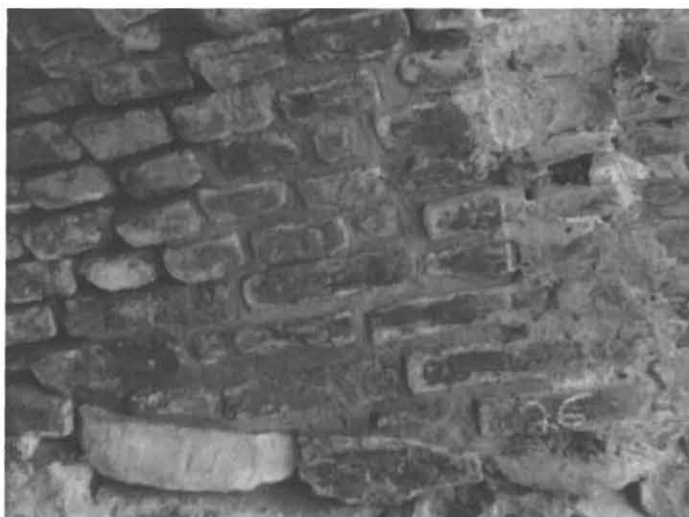
KUVA 14. Kuvan vasemmassa laidassa näkyy tiiliholvin avattuja saumoja, oikealla korjauksen lähtötilanne ja keskellä syksyn 2009 aikana hydraulisella kalkkilaastilla saumattua holvipintaa.
