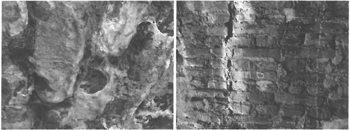
KUVAT 34 ja 35. Tiiliholvien pintaan on muodostunut kovaa kalkkikuorta.
