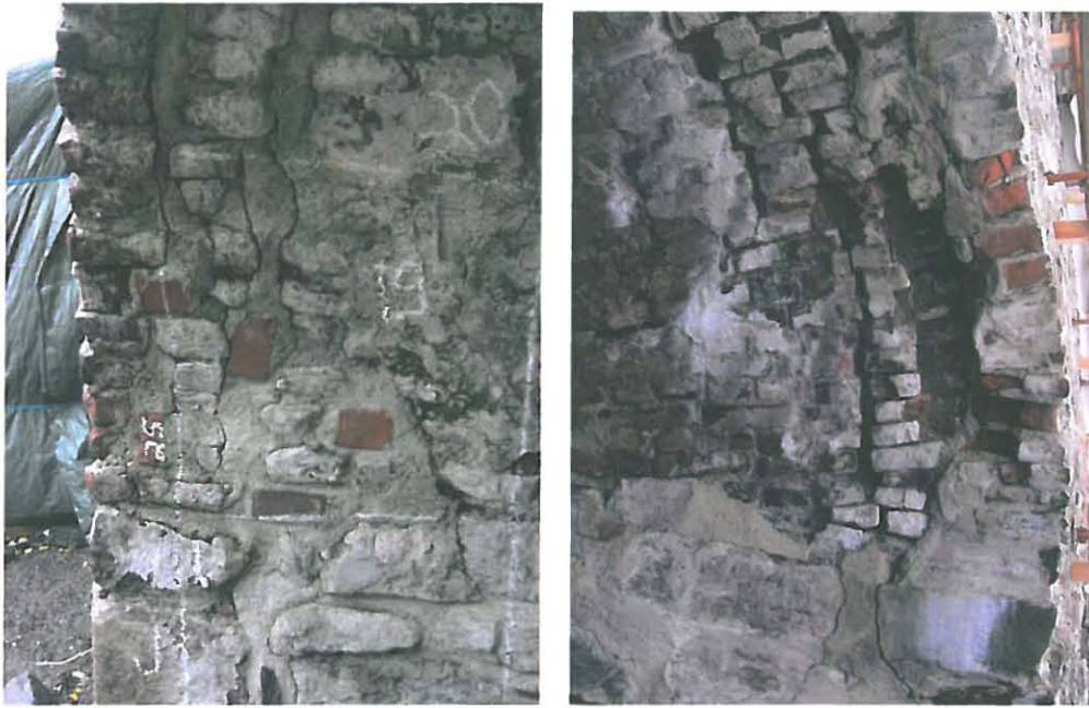
KUVAT 22 ja 23. Ampuma-aukon L 105 (vasemmalla) isot halkeamat on täytetty laastilla, mutta laastin ja tiilen väliin on jo syntynyt uusi rako. Oikealla ampuma-aukon L 207 vauriot ovat edenneet pitkälle.
