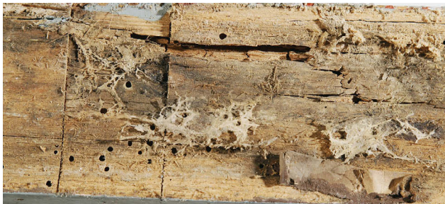
Kuva 5. Vauriokuva. Hometta ja hyönteistuhoa.
