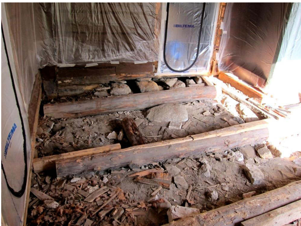
Kuvassa näkyy eteisen alapohja ennen parannustöitä. Osa vazoista lepää suoraan maan päällä.
