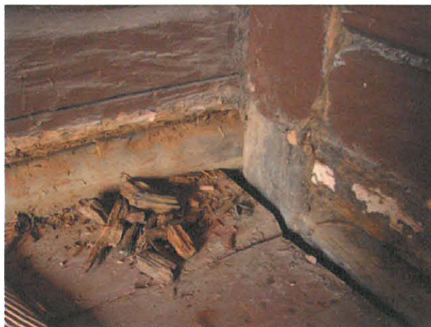
Kuva 18. Sivurakennuksen hirsivauriot alkavat paljastua eteisen lattialistojen takaa lounaisnurkassa. (J.Toivio)
