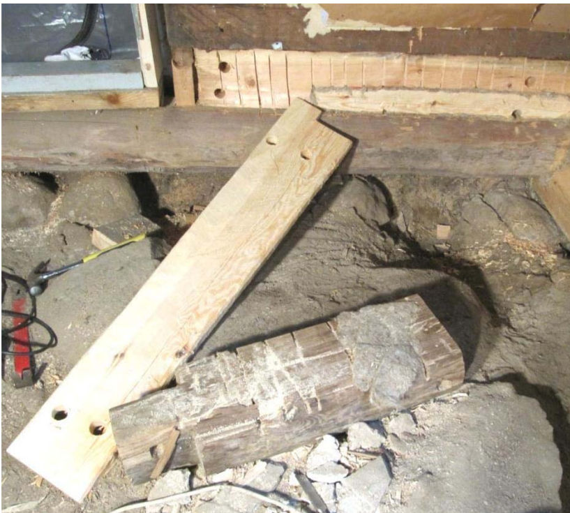
Kuvassa näkyvillä pienempi paikka, joka tehtiin ennen päällimmäisen paikan kiinnittämistä. Vasemmalla näkyy myös karapuun ja karmin alaosan puukorjaukset. Kunniahuoneen eteläseinä, oven oikea puoli.
