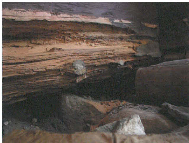
Kuva 19. Lisää eteisen hirsivaurioita löytyi koillisnurkasta. (J.Toivio)
