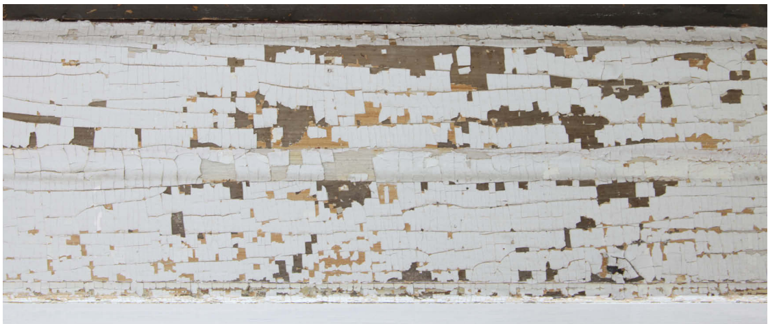
Ikkunalistan voimakas krakeloituminen ja maalin irtoamat ennen maalin kiinnitystä
