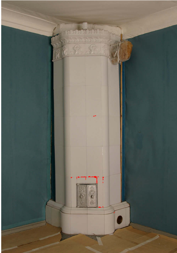
Kaakeliuunin halkeamat ja lohkeamat on
