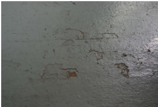
Vierashuoneen lattian krakeloitunut maali-pinta
