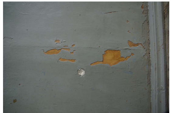
Vaurioalue liimakiinnityksen jälkeen
