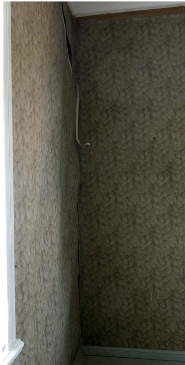
Länsiseinän pahvi on irvennyt ja irronnut pahvi pussittaa
