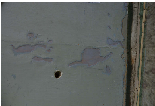
Vaurioalue pohjamaalauksen jälkeen
