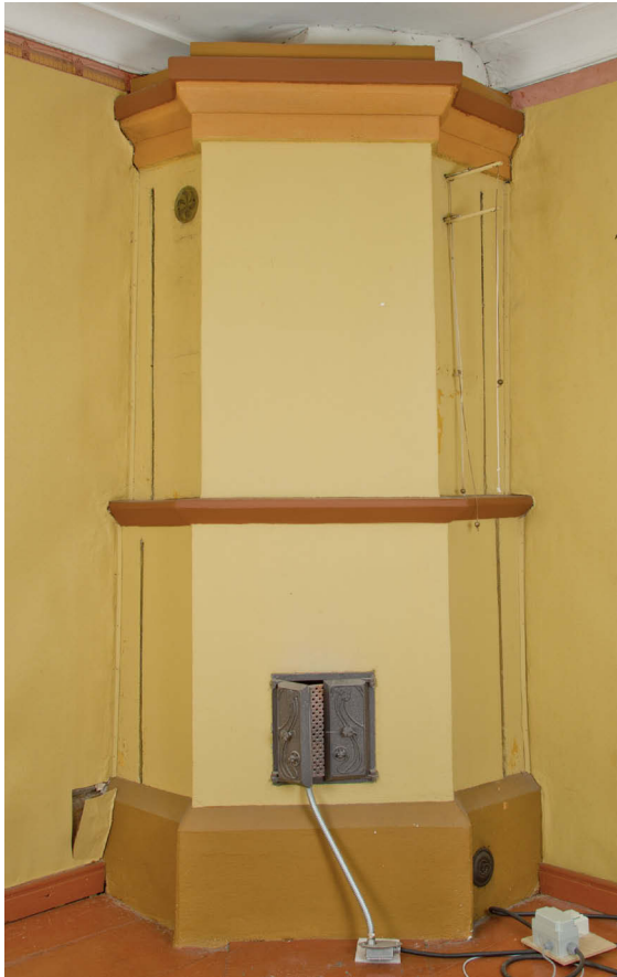
Kuva 28: Uuni ennen konservointia.
