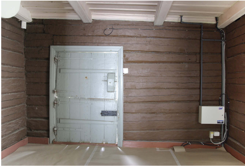
Kuva 35: Itäseinä ennen konservointia ja restaurointia. Nurkassa oli iso paloilmoinjärjestelmän keskusyksikkö.
