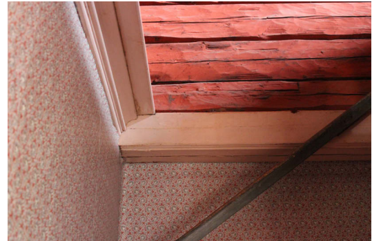
Kuva 7: Palkki maalinpoiston jälkeen.
