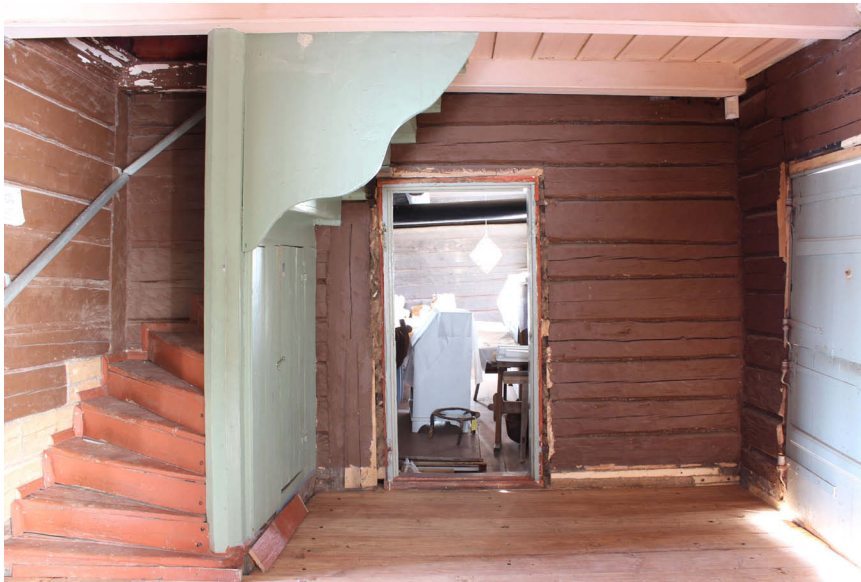
Kuva33: Pohjoisseinä hirsikorjausten jälkeen. Lattialle on tehty maalinpoisto ja ovet ja listat on irrotettu ja viety konservoitavaksi.
