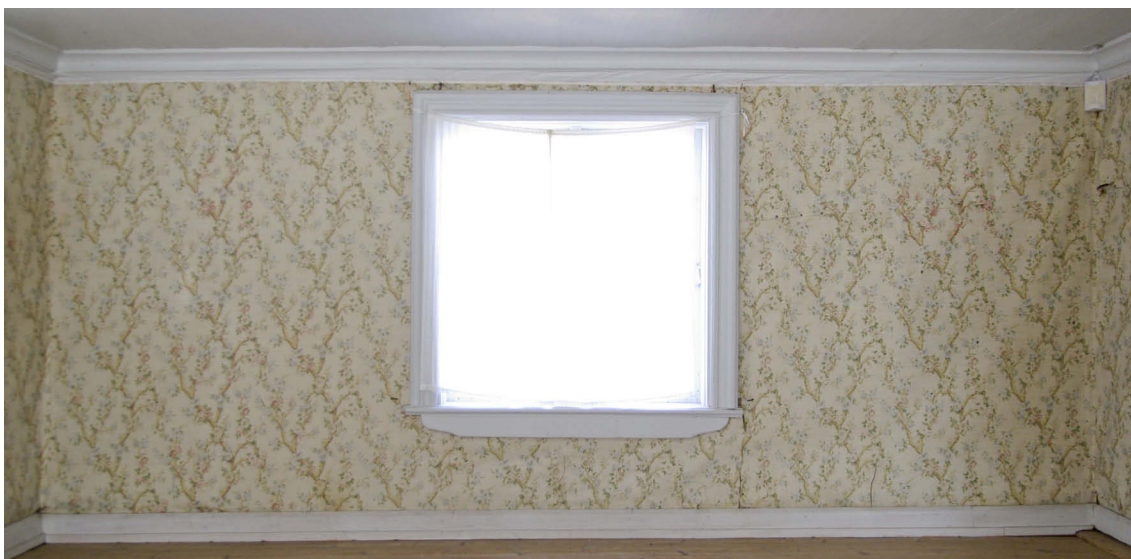
Kuva 58: Länsiseinä ennen konservointia ja restaurointia.
