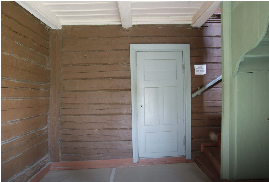
Kuva 41: Länsiseinä ennen konservointia ja restaurointia.
