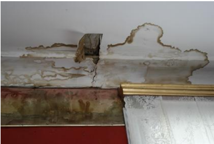
katon vesivauriokohta v. 2009 kuva: Emilia Bergholm
