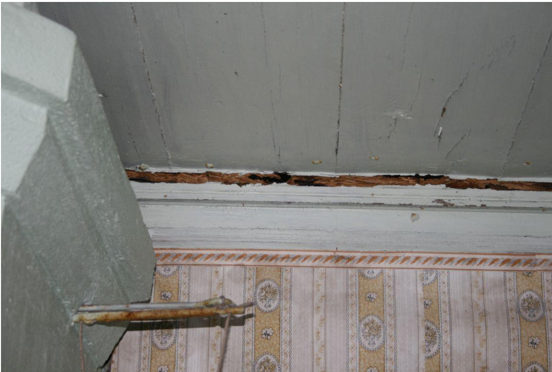
Yläkerran eteläpäädyn huoneessa oleva rakenteiden repeämä
