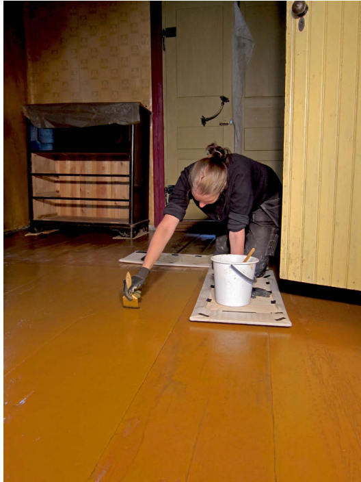
Tanja Lidfors maalaa toista maalikerrosta. Työ tehtiin osissa, jotta tilan läpi pystyi kulkemaan.
