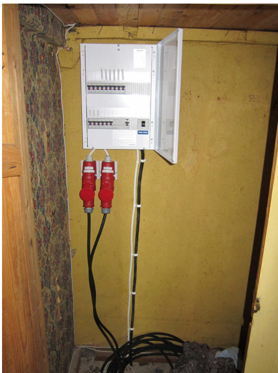
Eteisen kaapin ryhmäkeskus ja lämpöpumpun pistorasiat.
