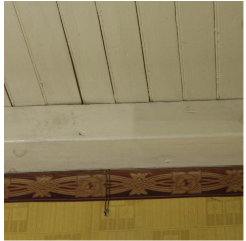
Puhdistettua ja puhdistamatonta kattopintaa.
