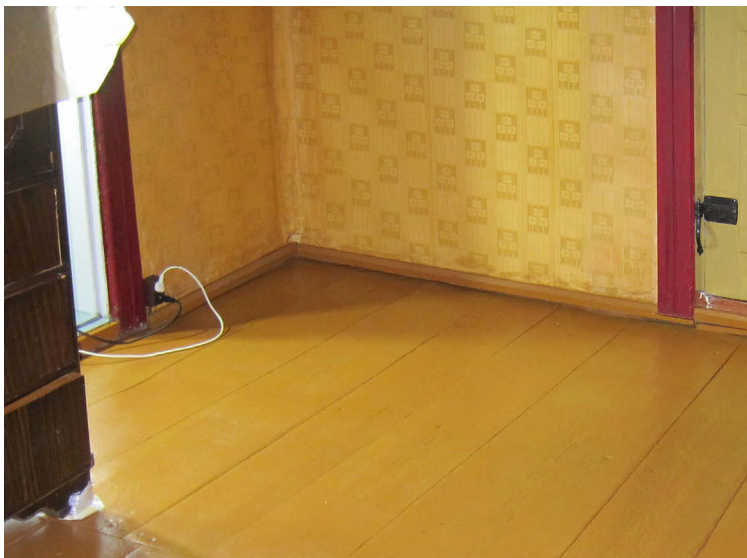
Eteisen pistorasia länsiseinällä
