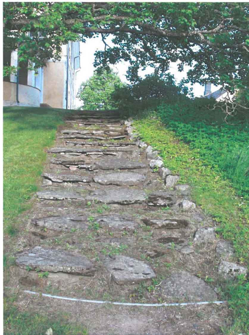
Päärakennuksen vieressä olevat huonokuntoiset kiviportaats, joilla on aiemmin kasvanut tuoksuorvokkia. Portaiden kunnostus edellyttää hiekkaperustuksen uusimista ja kiven tarkkaa latomista entisille paikoilleen.
