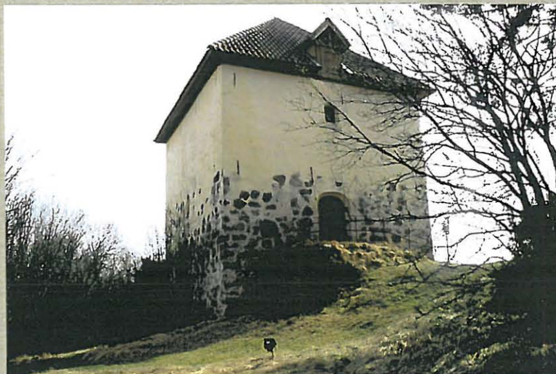
4. Linnan erijaha, takana portin kohta? Toivras on tehty 1900-luvulla. Portaitikon läpi pääsee sadevesi etuhuoneeseen - ongelma täytyy hoitaa.
