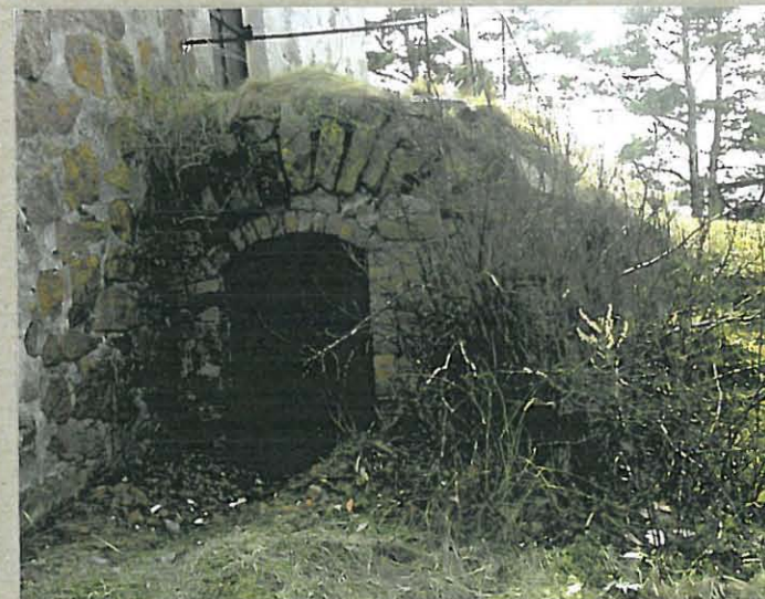
6. Ovi puuttuu. Pensas on jo poistettu – eikä uusia päästetä enää kasvamaan.
