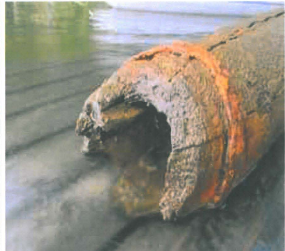
k.11 Pumppuputki n. 275 cm x n. 20-24 cm.
