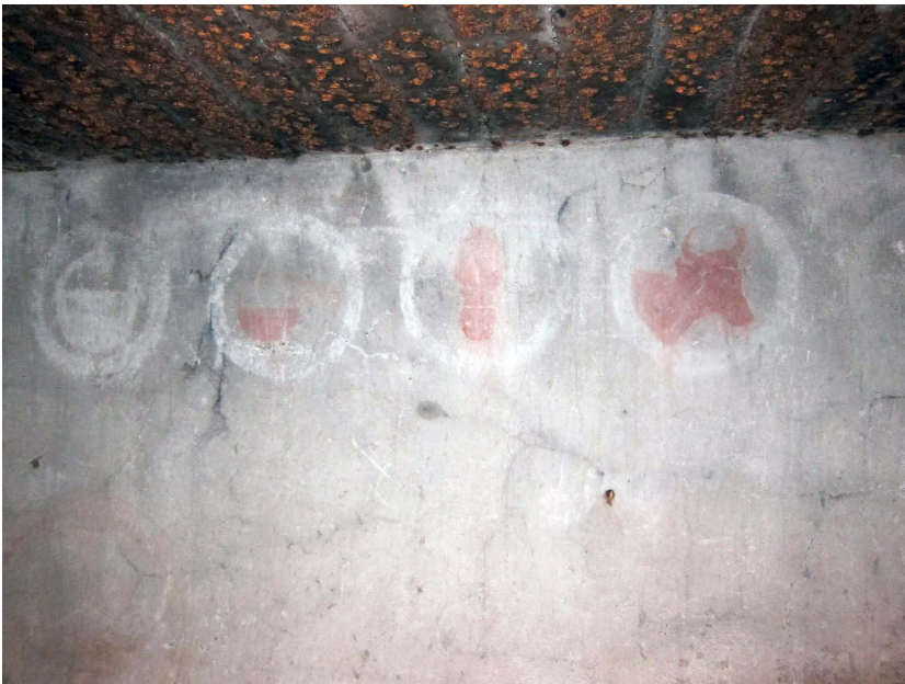
Kuva 24. Edellinen tilanne. Maalausten eteläpuolisko. Kuvaussuunta ENE. 12.10.2012.
