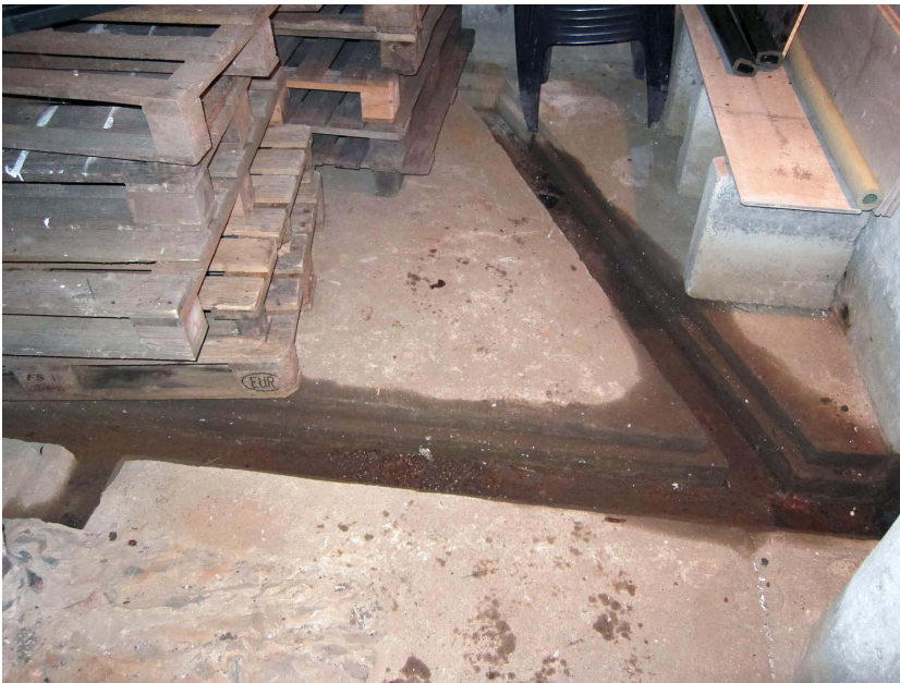
Kuva 35. Itäisen huonetilan lattiaa kiersi porrastettu kouru, joka johti veden pois eteläseinän läpi. Kuvaussuunta ENE. 10.10.2012.
