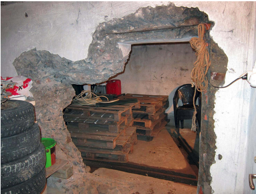
Kuva 17. Huonetilojen välinen oviaukko väliseinän eteläosassa. Seinää oli rikottu oviaukon pohjoispuolelta. Kuvaussuunta ENE. 10.10.2012.
