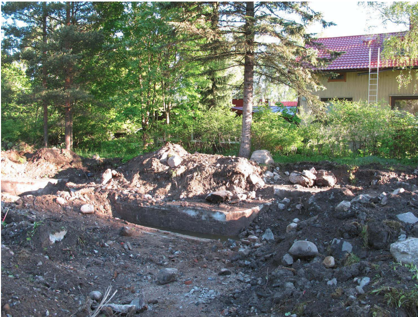
Kuva 1. Juoksuhaudantie 8 aamulla 4.6.2012 päivää ennen kaupunginmuseon tekemää tarkastuskäyntiä. Tontin pohjoissivun keskellä on vielä betonoituja taistelu-/yhdyshautoja. Kuvaussuunta NW. 4.6.2012.
