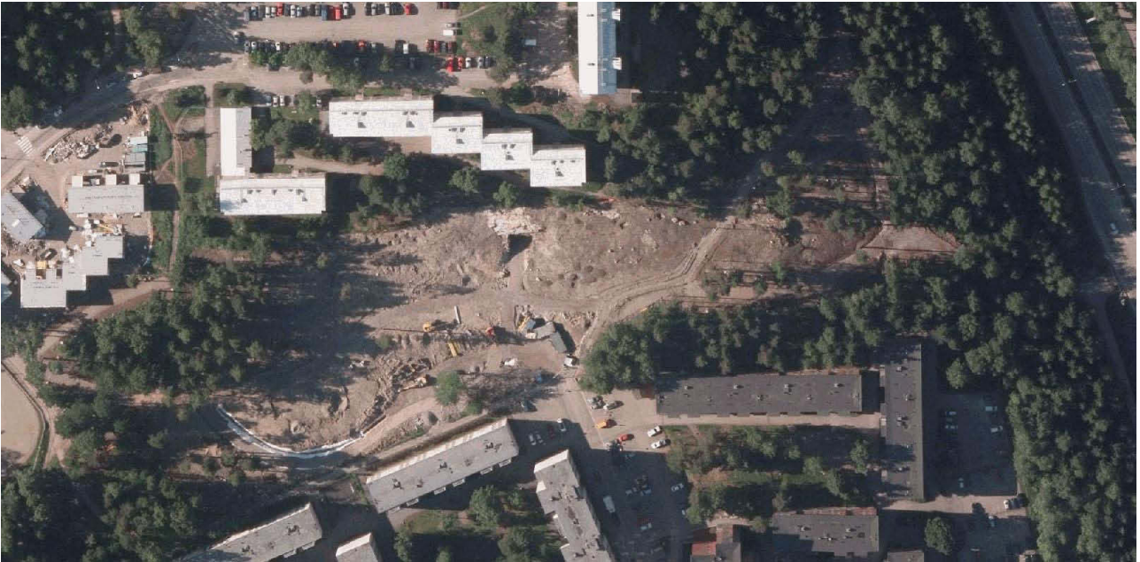
Ilmakuva alueesta v. 2013 kunnostustöiden aikana. Valvonta-alue erottuu selvästi rakennettavana alueena. Kuva: Helsingin kaupunki.
