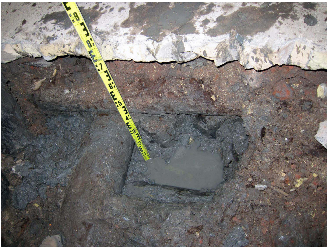
Kuva 8. Kellari 2. Edellinen kohta pohjaveden poistamisen jälkeen, jolloin lähimpänä näkyy alempi poikittainen hirsi. Latan alla on vielä syvemällä hirsi. Kuvaussuunta WSW. 3.10.2011.
