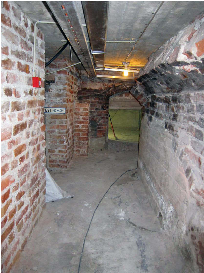
Kuva 26. Kellari 3. Kellarikäytävä 3. Vasemmalla on kellari 6 ja oikealla kulman kohdalla alkaa oikealle pohjoiseen päin menevä kellarikäytävä 7. Katto on vaihdettu betoniin. Taustalla on kellari 8. Kuvaussuunta W. 3.10.2011.
