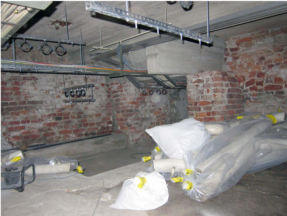
Kuva 48. Kellari 16. Täälläkin tiilinen kattoholvi vaihdettu betoniseen. Tilan kaakkoiskulmasta alkaa kellarikäytävä 15. Kuvaussuunta SE. 3.10.2011.
