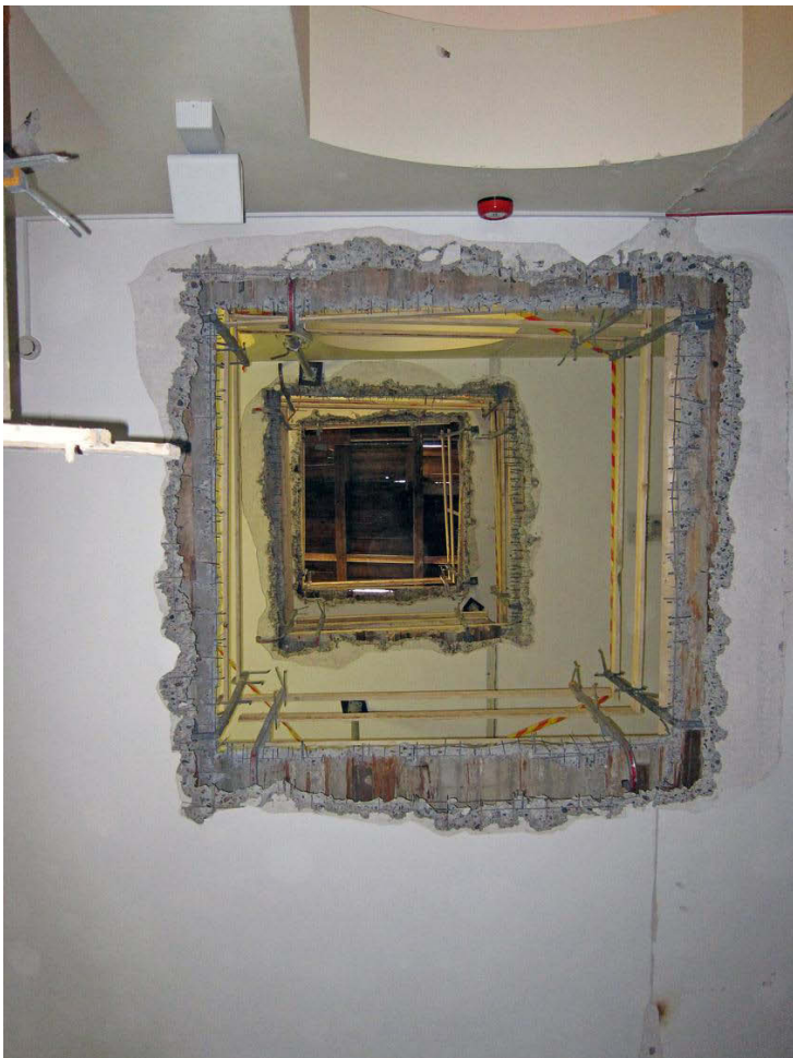
Kuva 16. Kellari 8. Hissiä varten kaikkiin kerroksien lattioihin tehtiin aukot. Kuvan yläosassa on pohjoinen. 3.10.2011.
