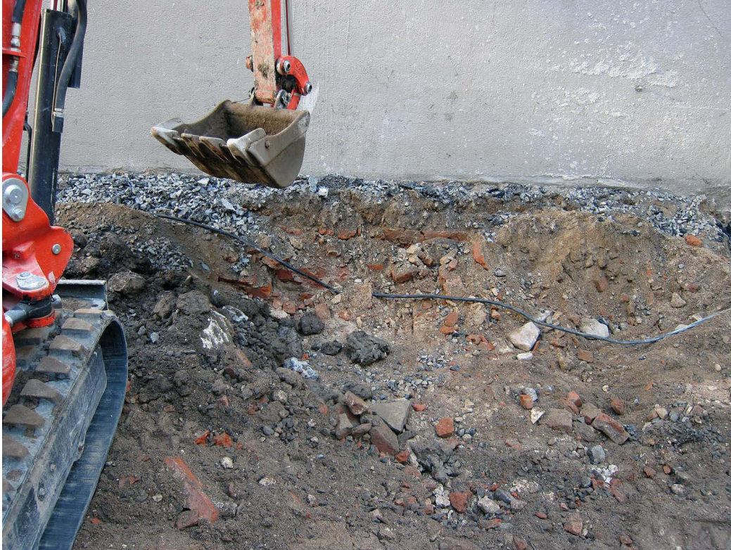
Kuva 93. Piha. Edellisen kohdan eteläpuolta kaivetaan aiemmassa vaiheessa (17-19 m). Pihan itä seinän edestä tulee esiin entisen piharakennuksen tiiliseinä purkukerroksen alta. Kuvaussuunta E. 4.11.2011.
