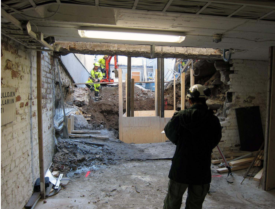
Kuva 55. Piha. Pihan koilliskulmaan tuli syvemmälle kaivettava kolmannen hissikuilun perustus (0-5 m) paalujen ja vanerilevytyksen kohdalle ja sen takana entisen ja uuden piharakennuksen kohta ( dokumentointikohta 3 ). Kuva on otettu pohjoispuolisen tontin kellarista, jonka eteläseinä on purettu. Kuvaussuunta S. 4.11.2011.
