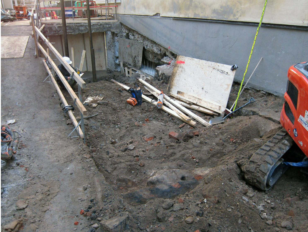
Kuva 73. Piha. Hissikuilun ja luiskan kohta myöhemmässä vaiheessa (0-11 m). Edellisten rakenteiden eteläpuolelta tuli esiin kuvan etualalla puretun piharakennuksen poikittainen tiilimuuri ja tummaa kreosoottia sen eteläpuolelta. Kuvaussuunta NNE. 7.11.2011.
