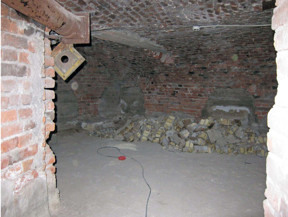
Kuva 23. Kellari 5. Kellarissa on kasattuna lattiosta purettuja keltaisia tiliä. Kuvaussuunta SE. 3.10.2011.
