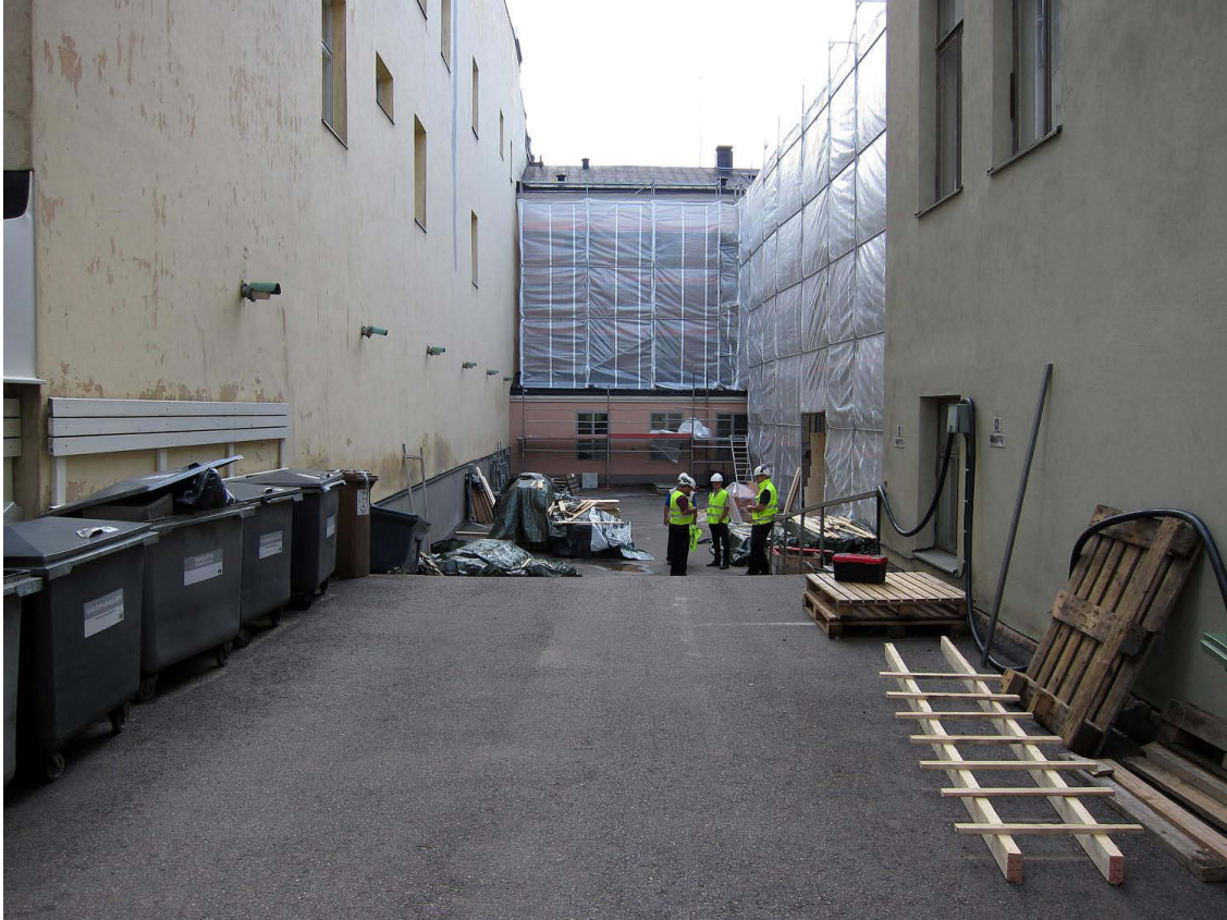
Kuva 1. Piha. Goviniuksen talon piha pohjoispuolisen tontin pihalta kuvattuna ennen maankaivutöitä. Kuvaussuunta S. 17.8.2011.
