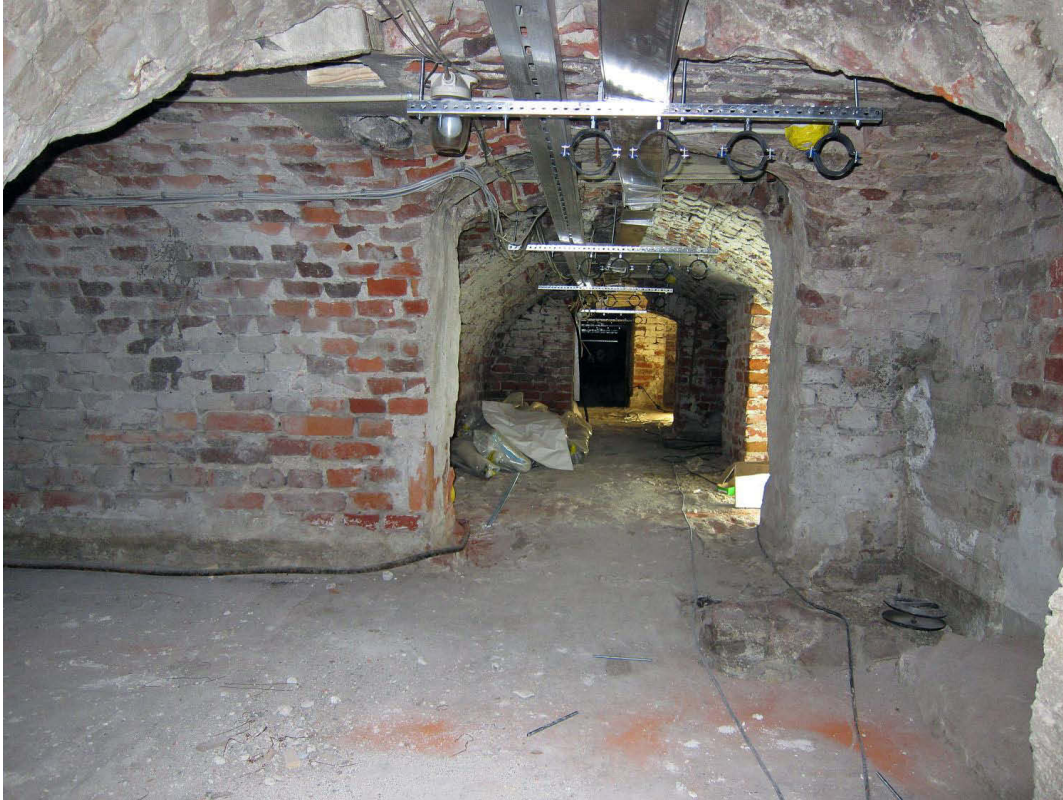
Kuva 35. Kellarit 10, 11 ja 12. Edessä on kellarin 10 itäosa, keskellä kellari 11 ja taustalla kellari 12. Kuvaussuunta N. 3.10.2011.
