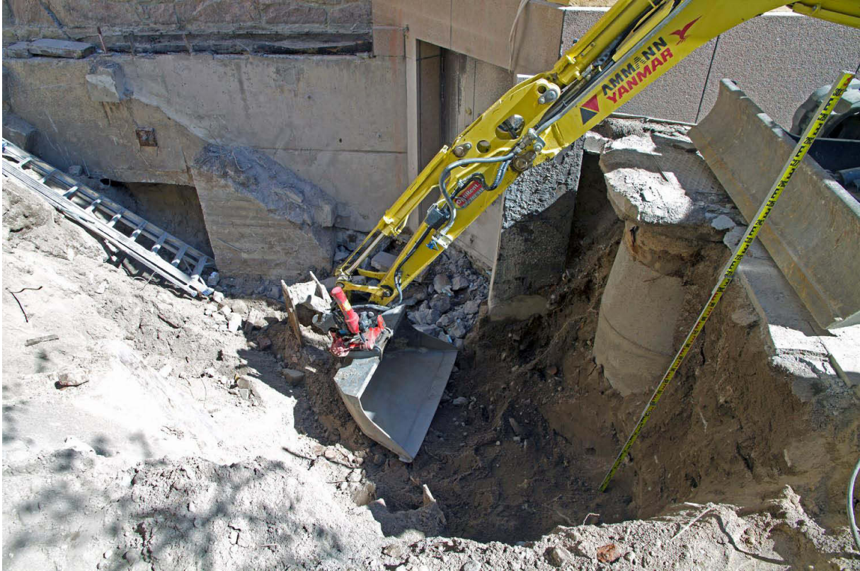
Kuva 41. Kaivanto portaikon kohdalla. Kauhan edessä ja takana näkyvät H-muotoiset pystypalkit, joiden välissä oli hirsiä. Rakenteet liittyvät vuosien 1985-88 rakennustöihin. Kuvaussuunta E. 16.5.2013.
