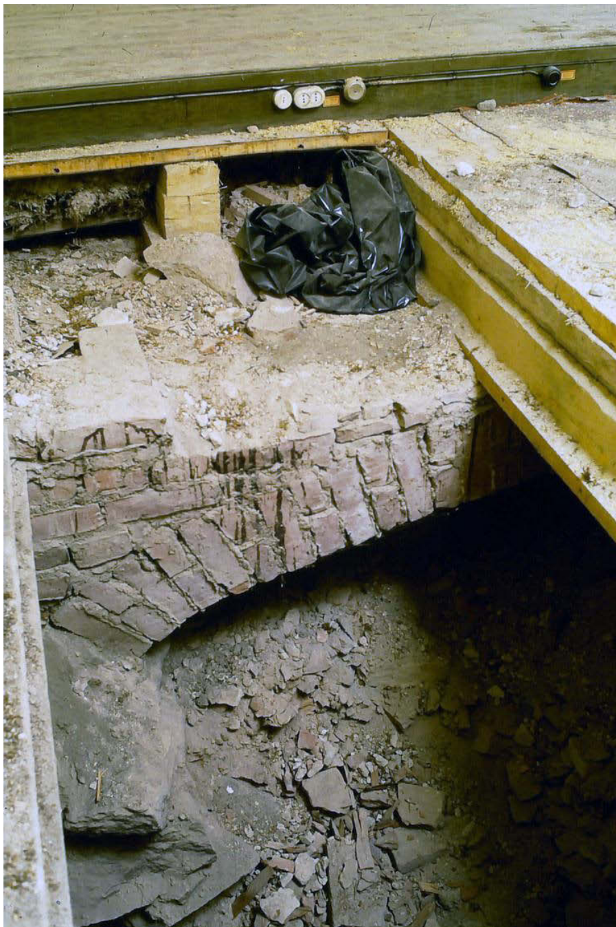
Nykyisen itäsiiven eteläpäässä kellarittoman tilan (kartta s. 36, huoneet 132-134 ja P006) lattiaa on avattu.
