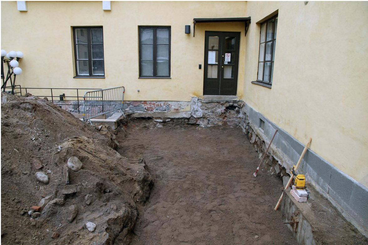
Kuva 25. Kaivetun alueen pohjoisosaan on levitetty pohjalle hiekkakerros. Oikealla näkyy uutta betoniperustaa. Rakennuksen sisällä sen kohdalla on tunneli etelän auditoriosta pohjoisen päärakennuksen kellariin. Kuvaussuunta N. 30.4.2013.
