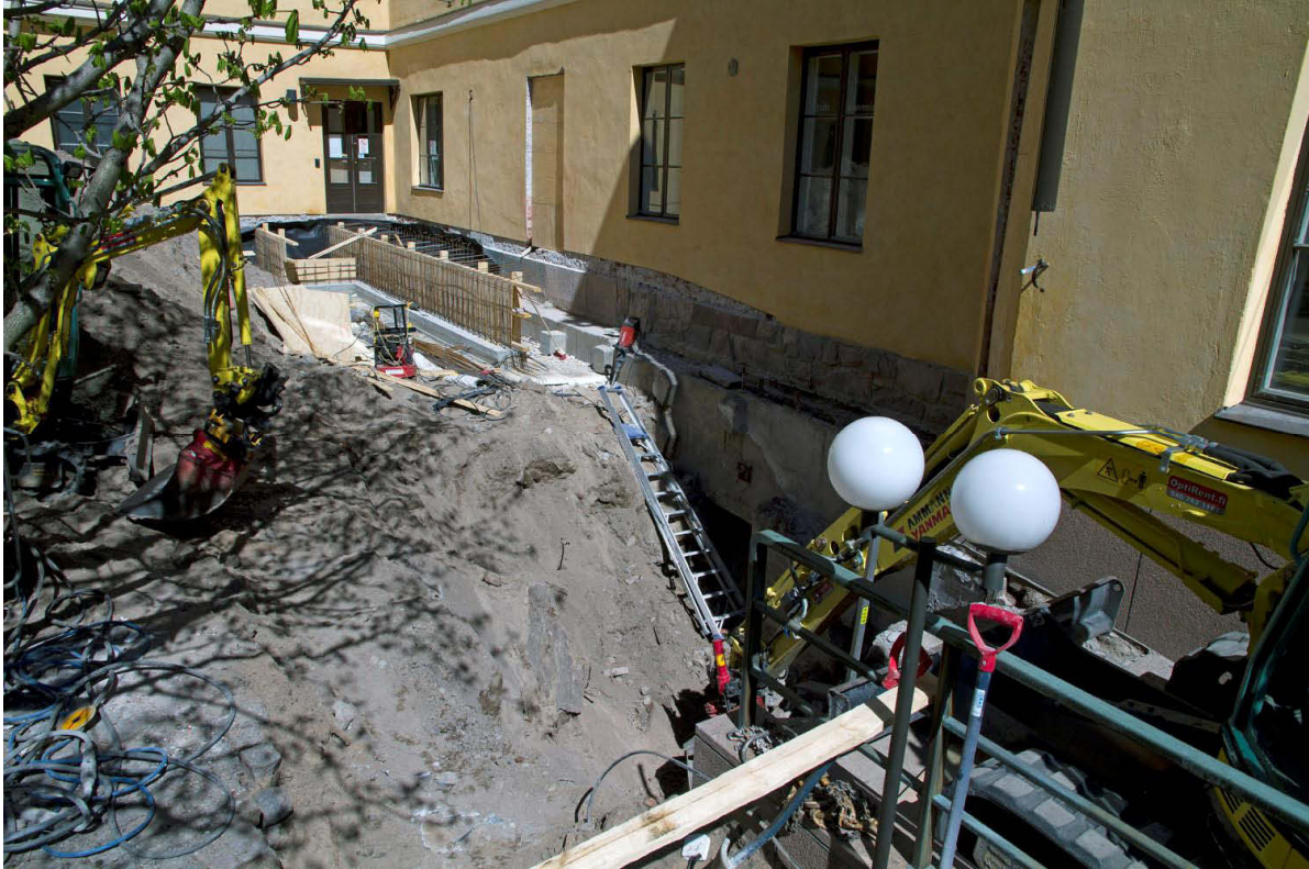
Kuva 39. Työmaan pohjoisosassa valutöiden valmistelu on edennyt ja eteläosassa portaikko on purettu ja kuopan aluetta on laajennettu. Kuvaussuunta NE. 16.5.2013.
