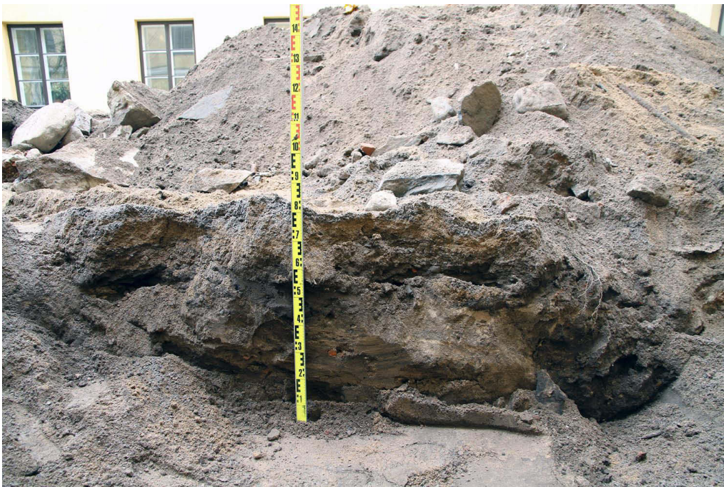
Kuva 14. Kaivetun alueen lounaisosassa edellisten portaiden lounaispuolelta ja päärakennuksen kellariin johtavien portaiden eteläpuolelta alkoi näkyä vanhoja kerroksia. Profili ennen puhdistusta. Kuvaussuunta W. 30.4.2013.
