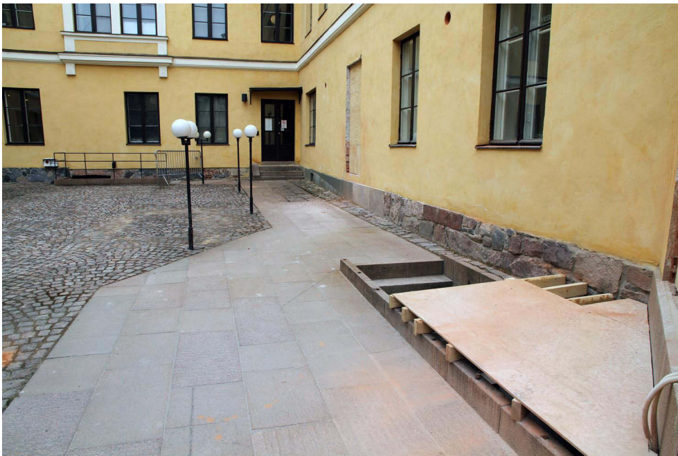
Kuva 4. Metalliporaat ja -luiska on purettu ja itäsiiven vuonna 1816-1819 rakennettuun osaan alkuperäisen porttikongin kohdalle on avattu uusi oviaukko huhtikuussa 2013. Samoin kuvan oikeassa reunassa on avattu oviaukko 1. kerrokseen vanhan kellariaukon yläpuolelle. Kuvaussuunta NNE. 26.4.2013.
