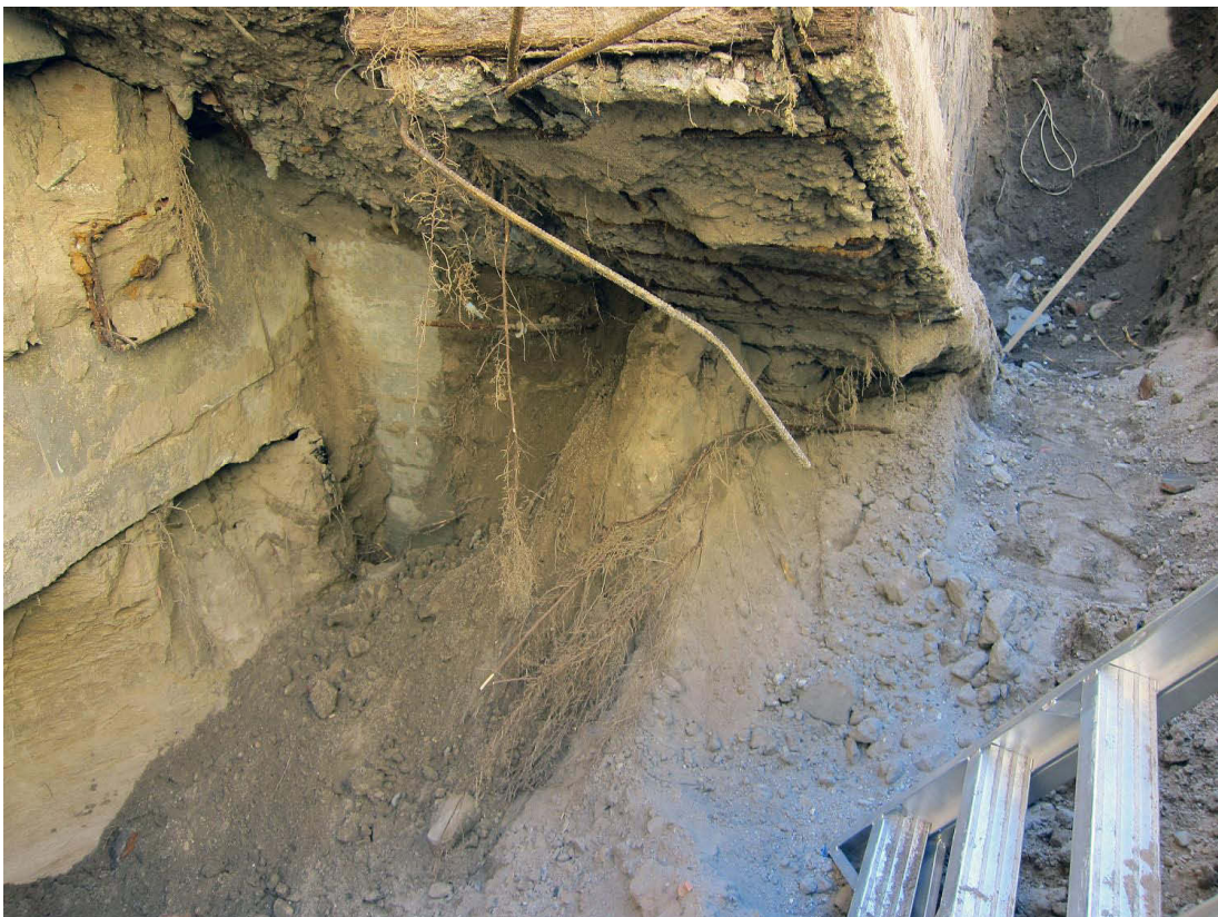
Kuva 34. Portaikon alapinta ja vasemmalla itäsiiven uutta (1985-88) perustusta, jonka alla on luonnollista hiekkaa. Kuvaussuunta SSE. 6.5.2013.
