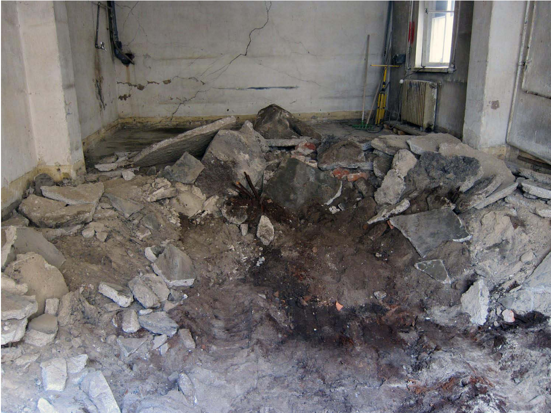
Kuva 225. Piharakennus, huone A. Betonilattia on purettu ja hiekka poistettu tilan eteläosasta. Kuvaussuunta N. 24.7.2012.
