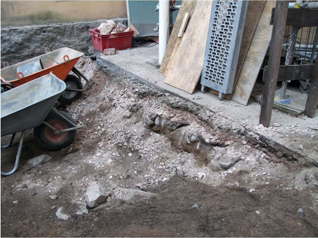
Kuva 155. Piha, eteläosa. Asfaltti ja sen alapuoliset maat saakka on poistettu tavoitekorkeuteen saakka pihan leveämmän eteläpuoliskon eteläosassa. Kuvan kohta sijaitsee rakennuksen päärunгон puolikaarenmuotoisen portaikon koillispuolella. Havaintopiste 6 sijaitsee tässä kohtaa. Kuvaussuunta SE. 15.10.2009.
