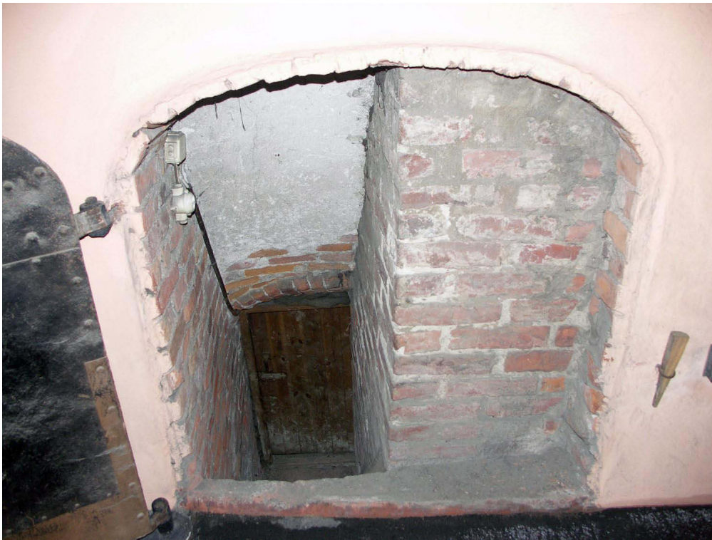
Kuva 64. Kellari VI. Portaikko kellariin, alaovi suljettuna. Kuvaussuunta N. 25.2.2009.
