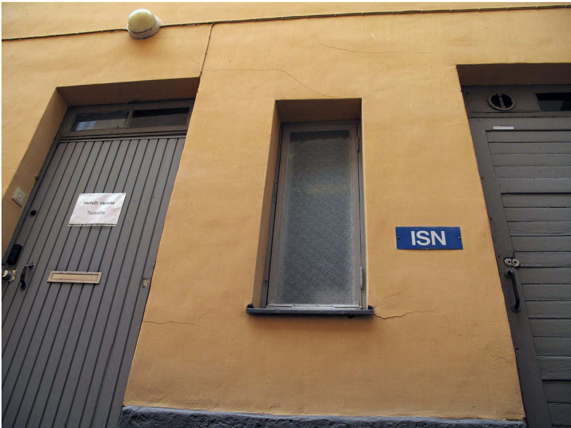
Kuva 129. Piha, pohjoisosa. Kaivautuminen rakennusten alle ilman mitään tukirakenteita näkyi seinien repeytymisenä melkein heti. Kuvassa piharakennus. Kuvaussuunta W. 22.9.2009.
