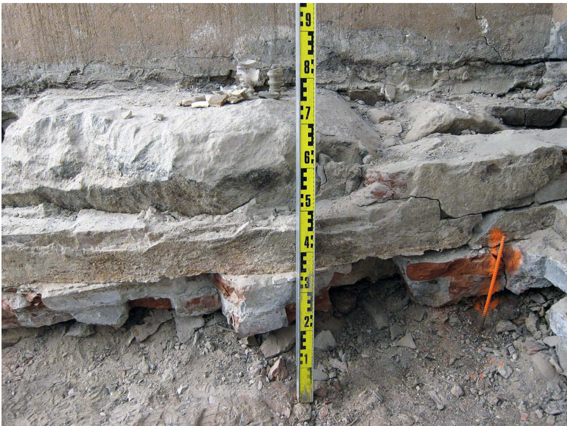
Kuva 250. Pih arakennus, huone B. Lähikuva tilan länsiseinän perustuksista. Kuvaussuunta S. 15.8.2012.
