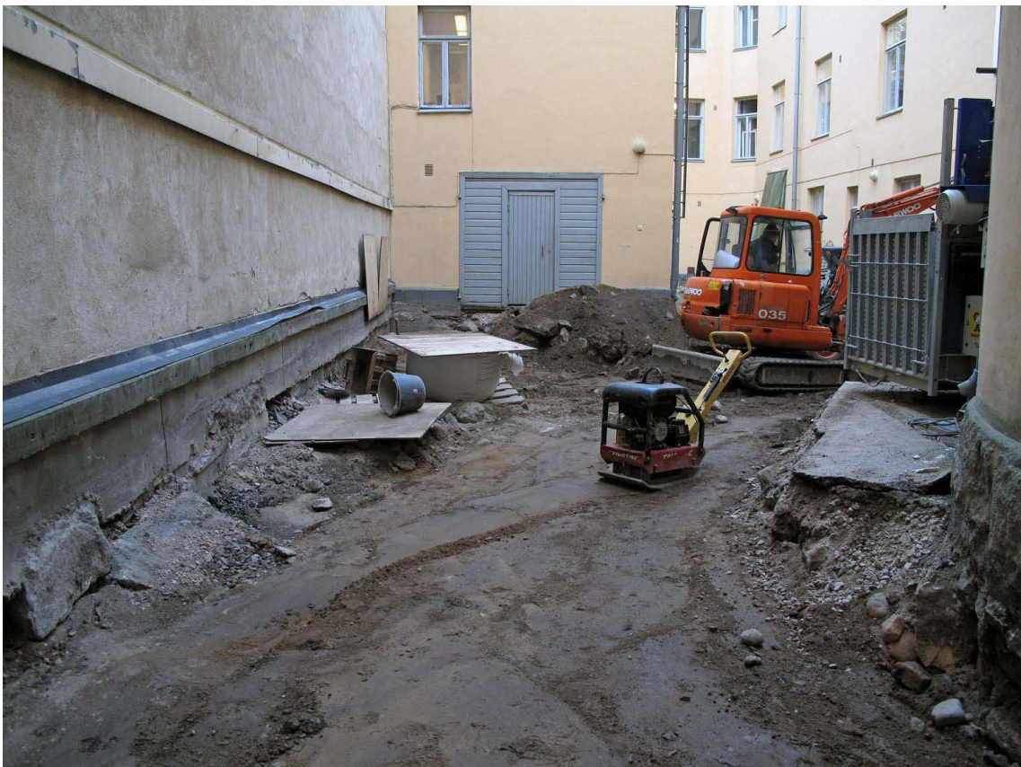
Kuva 160. Piha, eteläosa. Pihan länsiosa on kaivettu tavoitesyvyytensä ja pinta tiivistetty. Kuvaussuunta N. 15.10.2009.
