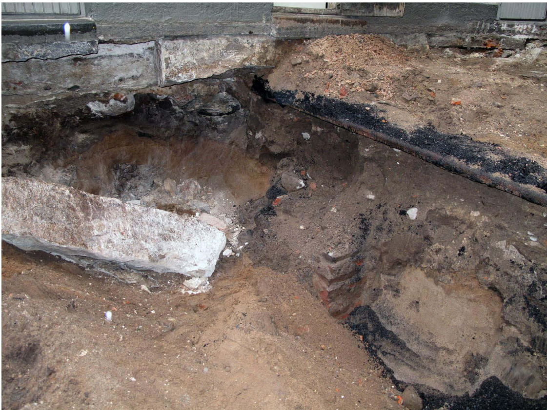
Kuva 122. Piha, pohjoisosa. Kaivannon länsipäästä kuvan 116 sekoittuneesta hiekasta tuli esiin syvemmälle kaivettaessa tiilirakenteinen viemärikaivo, johon edellä mainittu putki johti. Vasemmalla etualalla näkyy piharakennuksesta poistettu/pudonnut perustuskivi. Kuvaussuunta NW. 27.7.2011.
