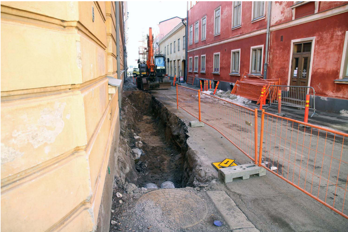
Kuva 263. Helen ankatu. Helsingin Energian Lampen taloon kaivama kaukojäähdytysputkikaivanto Helenankadun itäisen jalkakäytävän kohdalla. Kuvaussuunta S. 3.4.2013.
