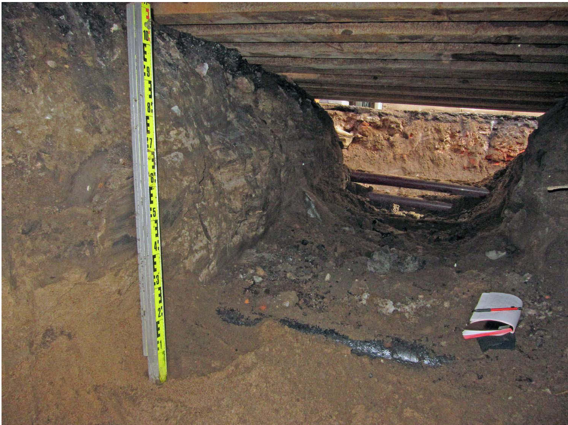
Kuva 273. Helen ankatu. Helenankadun poikki menevä kaivanto kuvattuna alhaalta kaivannosta käsin. Keskellä Helenankatua kadunsuuntaisesti meni vesi- ja viemäriinjat. Edessä on ilmeisesti viemäriputki. Kuvaussuunta E. 8.4.2013.
