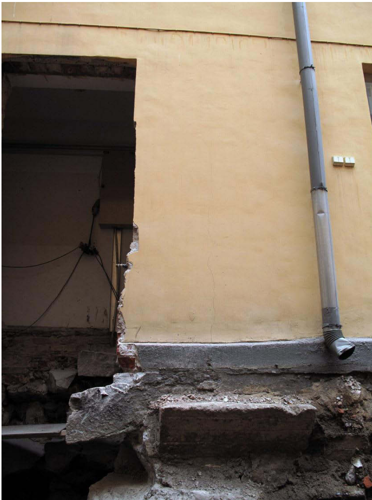
Kuva 131. Piha, pohjoisosa. Sama repeytyminen näkyi myös Mariankadun siiven seinässä. Kuvaussuunta E. 22.9.2009.
