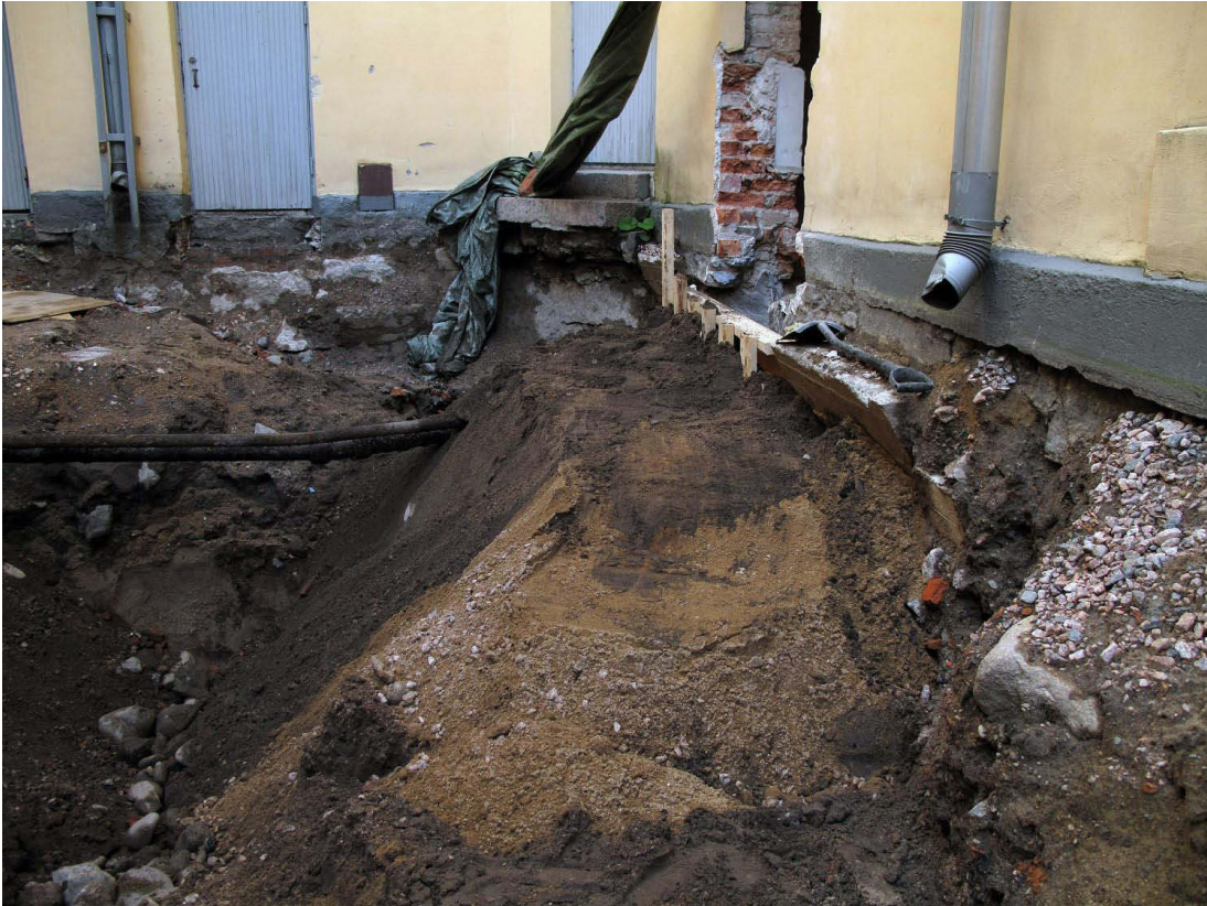
Kuva 133. Piha, pohjoisosa. Vastaava betonivahvistus tehtiin myös Mariankadun siiven seinän alle. Kuvaussuunta NE. 8.10.2009.
