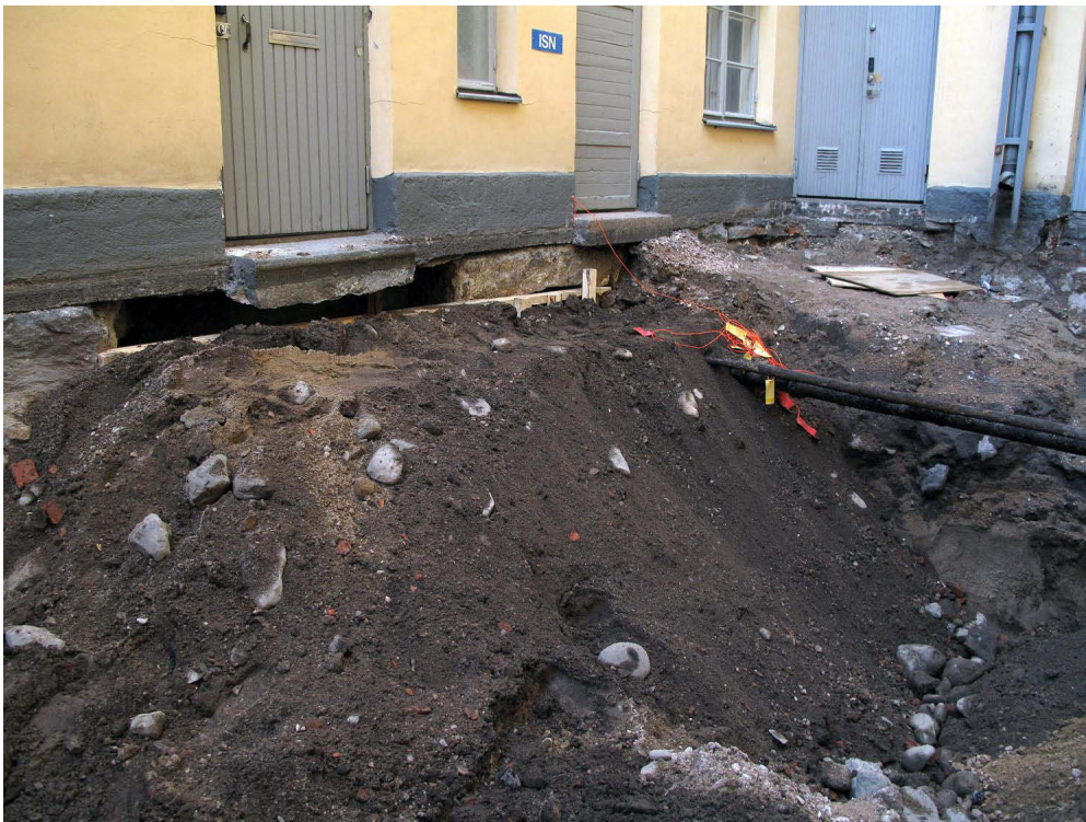
Kuva 132. Piha, pohjoisosa. Tunnelin rakentaminen lopetettiin rakennusten sortumisvaaran takia. Seinien alle tehtiin betonivalut. Kuvassa piharakennus. Kuvaussuunta NW. 8.10.2009.
