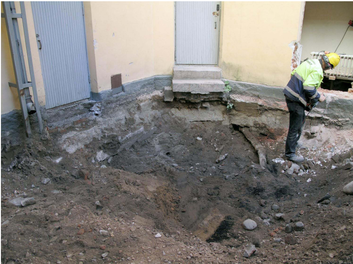
Kuva 107. Piha, pohjoisosa. Pihan koillisnurkasta tuli melko pian esiin metalliputki ja sen ympärillä sekoittuneita hiekköjä. Harmaa hiekka oli vuoden 1962 megapaalutuksen kaivannon täyttömaita, joka oli tuhonnut pihan koilliskulman ja itäreunan vanhat kerrokset leveältä alueelta. Kuvaussuunta NE. 15.9.2009.
