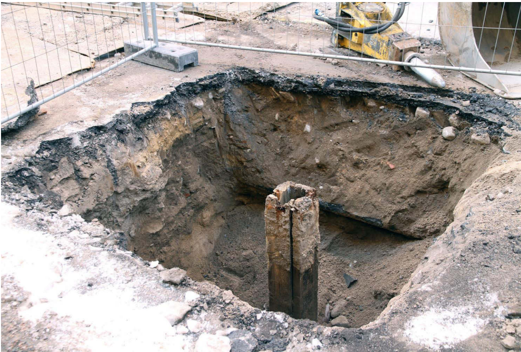
Kuva 277. Helen ankatu. Kuoppa Lampan porttikongin pohjoispuolella Helenankadun keskellä. Putkilinjojen takia profiileissa näkyy enimmäkseen vain uusia täyttökerroksia. Eteläprofiilissa näkyy alhaalla puhdasta hiekkaa. Kuvaussuunta SW. 3.4.2013.
