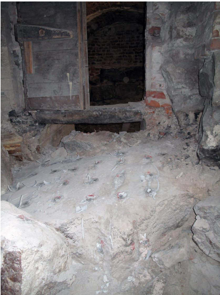
Kuva 22. Kellari II. Kalliota on porattu tilan lattiapinnan alentamisen takia kellari III oviaukon edessä. Kuvaussuunta E. 8.10.2009.
