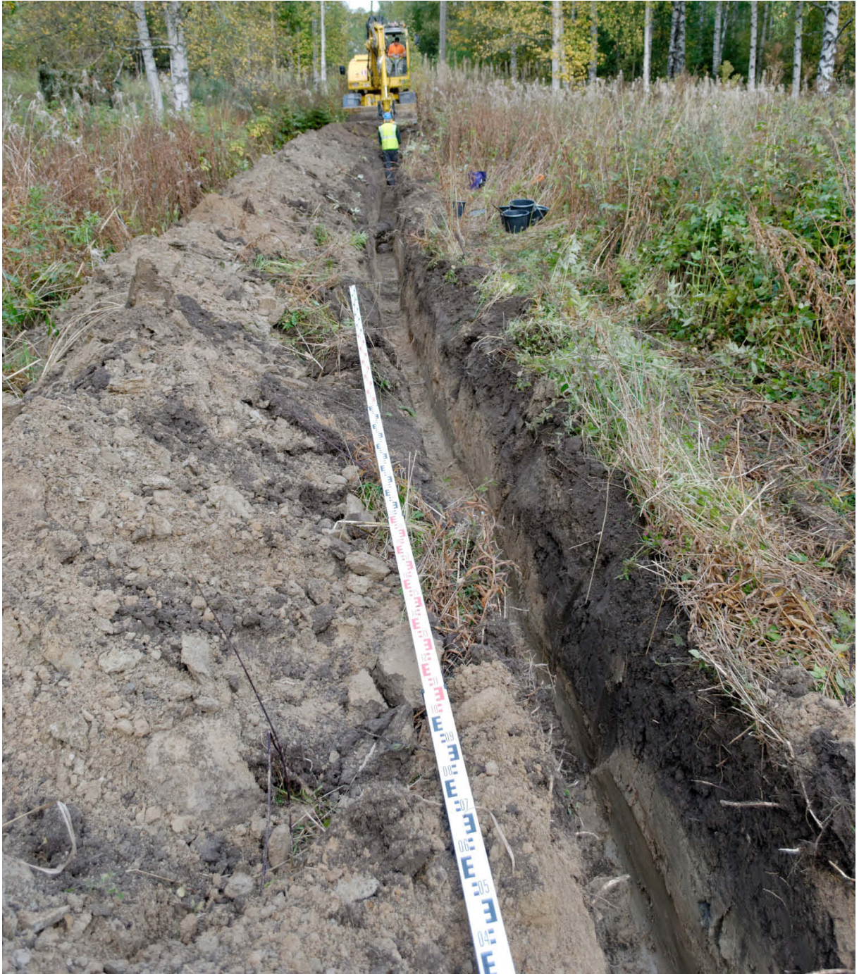
Kuva 2. Kaivanto 2:n N-seinämää noin 5–10 metrin kohdalla. Multasavella täytetty kaivanto n. 5,5–8 metrin kohdalla. Kuvattu kaakosta. AKDG3322_008
