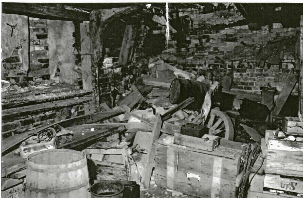
Puutyöverstas ennen korjausta. SatM.
